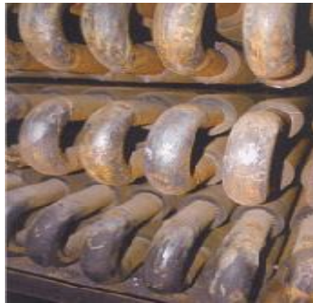
Şekil 2.48. Isı değiştiricilerde yüksek sıcaklık korozyonu [127]
