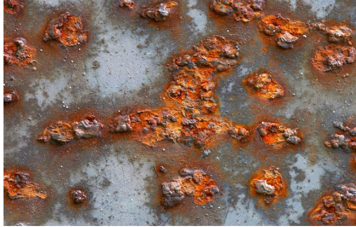
Şekil 2.45. Taneler arası korozyon hasarı [108]
