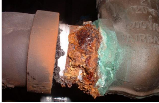
Şekil 2.42. Petrol ve gaz hattındaki galvanik korozyon [108]
