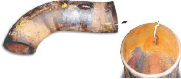
Şekil 2.49. Boru ek yerinde erozyon korozyonu [127]
