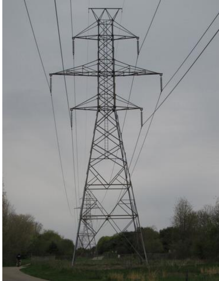
Şekil 3.6. Çok yüksek gerilim kulesi
