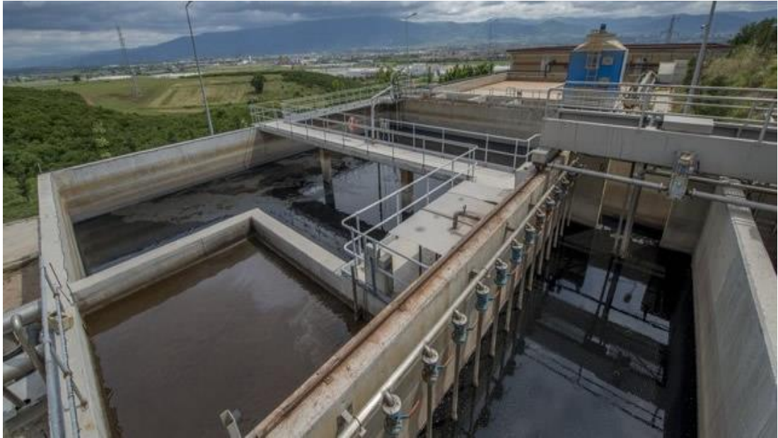
Şekil 3.7. Çöp suyu arıtma tesisi genel görünümü
