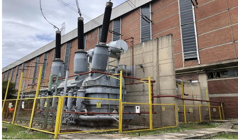
Şekil 3.8. Dış saha trafosu
