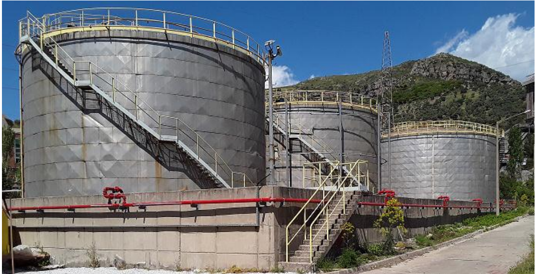
řekil 3.9. Fuel oil depolama tankı
