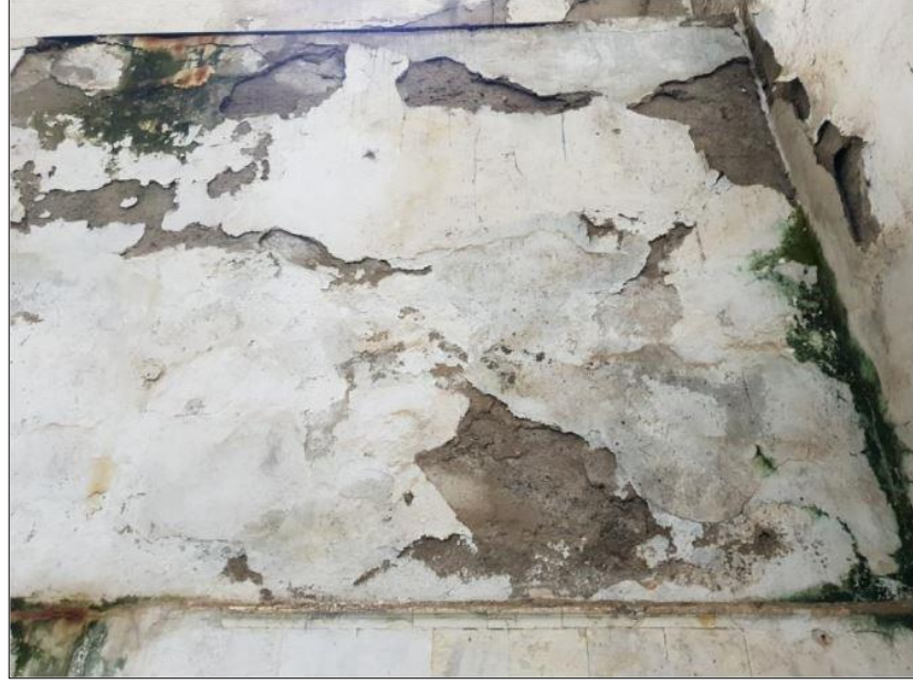
Şekil 5.174. Z02 Makine dairesi duvarlarındaki hasarlar
