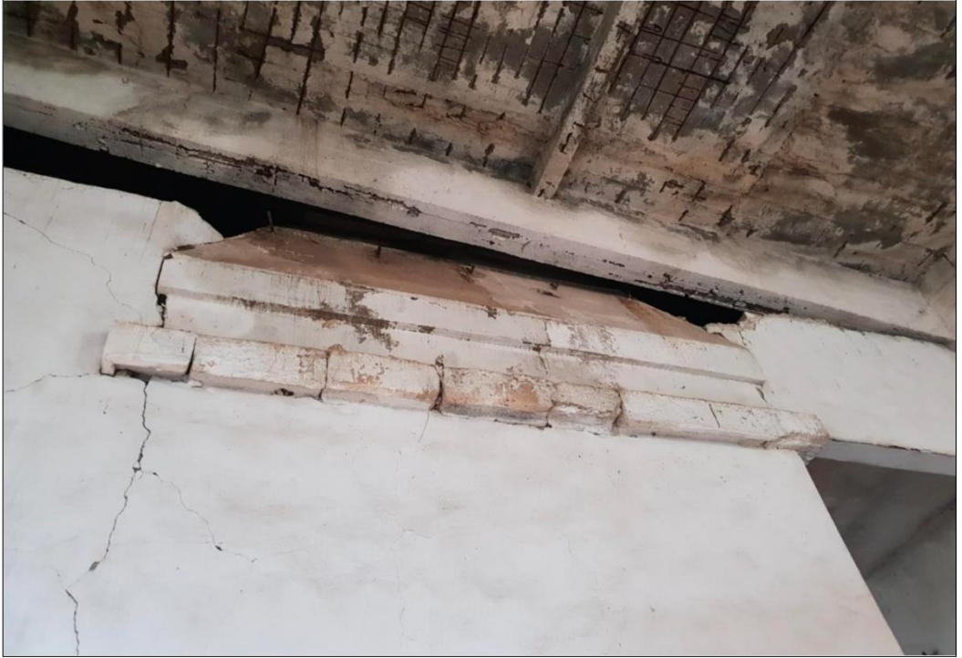
Şekil 5.118. Z01 nolu hacim , Bacaya ait taş korniş ve donatıları açığa çıkmış betonarme çatı örtüsü
