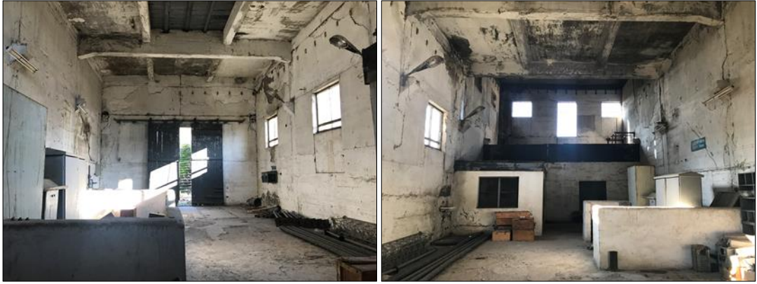
Şekil 5.158. Z06 kodlu elektrik bakım-onarım odası (Yazarın Fotoğraf Arşivi)
