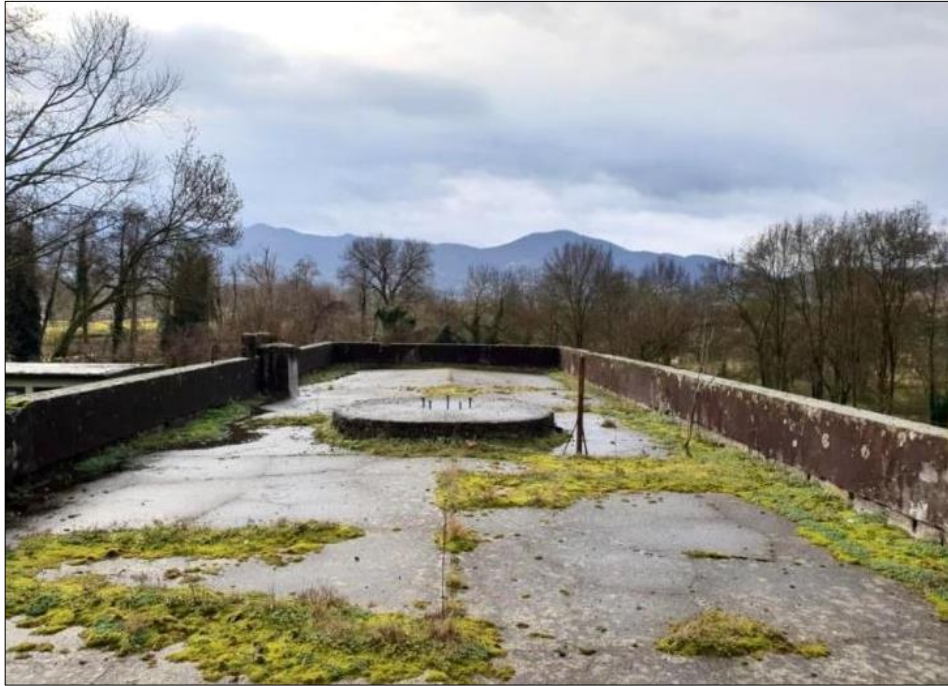
Şekil 5.170. Çatı üzerindeki yoğun yosunlanma ve kabuk oluşumu (Kartepe Belediyesi Arşivi)
