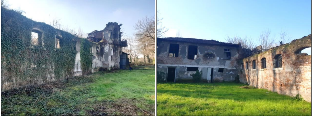
Şekil 5.94. Ahır yapısının hasarlı cephe görüntüleri (Kartepe Belediyesi Arşivi, 2018)
