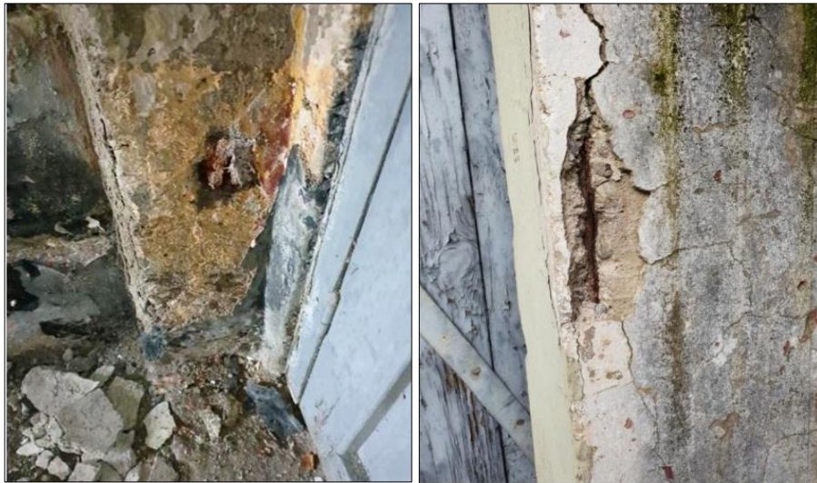
Şekil 5.175. Yapının iç (solda) ve dış duvarlarında(sağda) açığa çıkan donatılar
