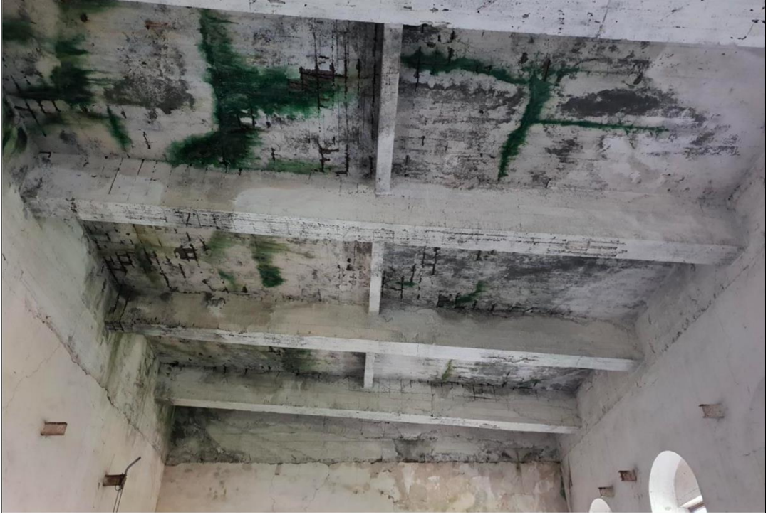
Şekil 5.123. Z02 nolu hacim (AMBAR-2)- Tavanda yoğun rutubet sonucu oluşan yosunlanma
