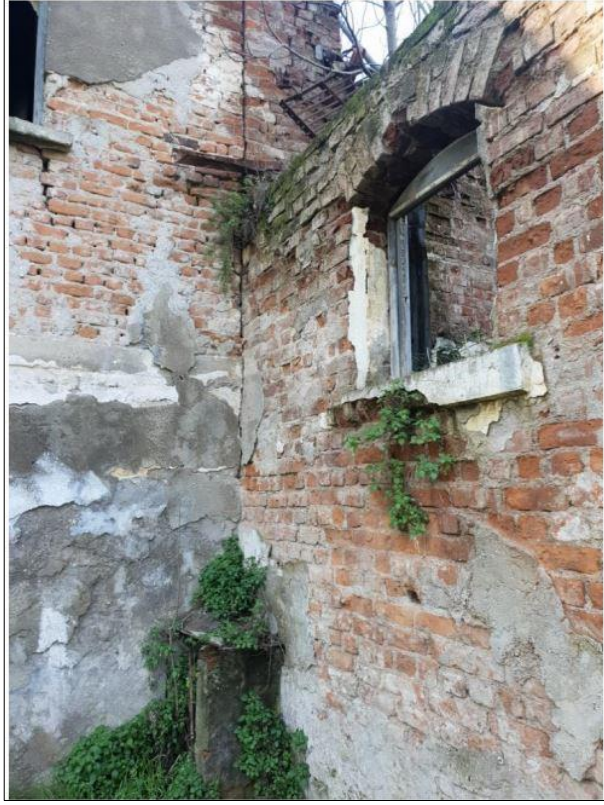
Şekil 5.86. Güney cephesinde ana kol ile betonarme kısmın ayrı olarak inşa edildiğini gösteren duvar örgü izi
