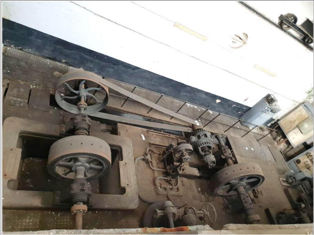
Şekil 5.177. Korozyon görülen santral tirbün elemanları
