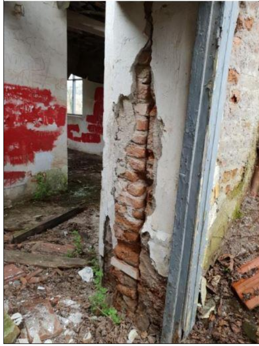
Şekil 5.85. 101 ve 106 nolu mekanlar arasında yer alan kapı geçişinde birbiri ile kenetlenmeyen duvar örgüsü
