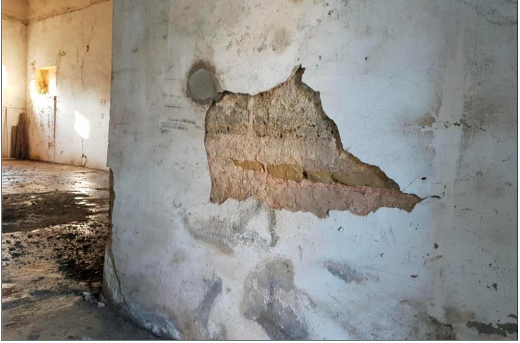
Şekil 5.117. Z01 nolu hacim (AMBAR-1)- Sıva dökülmesi sonucu ortaya çıkan duvar dokusu
