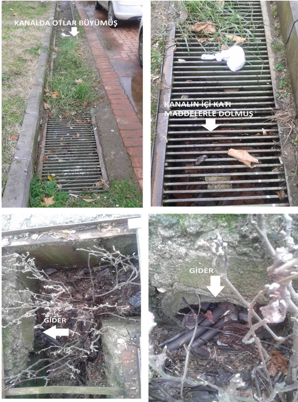
Şekil 4.5. Binaların etrafını çevreleyen yağmur suyu kanallarında meydana gelen tıkanmaların sebeplerine örnekler.
