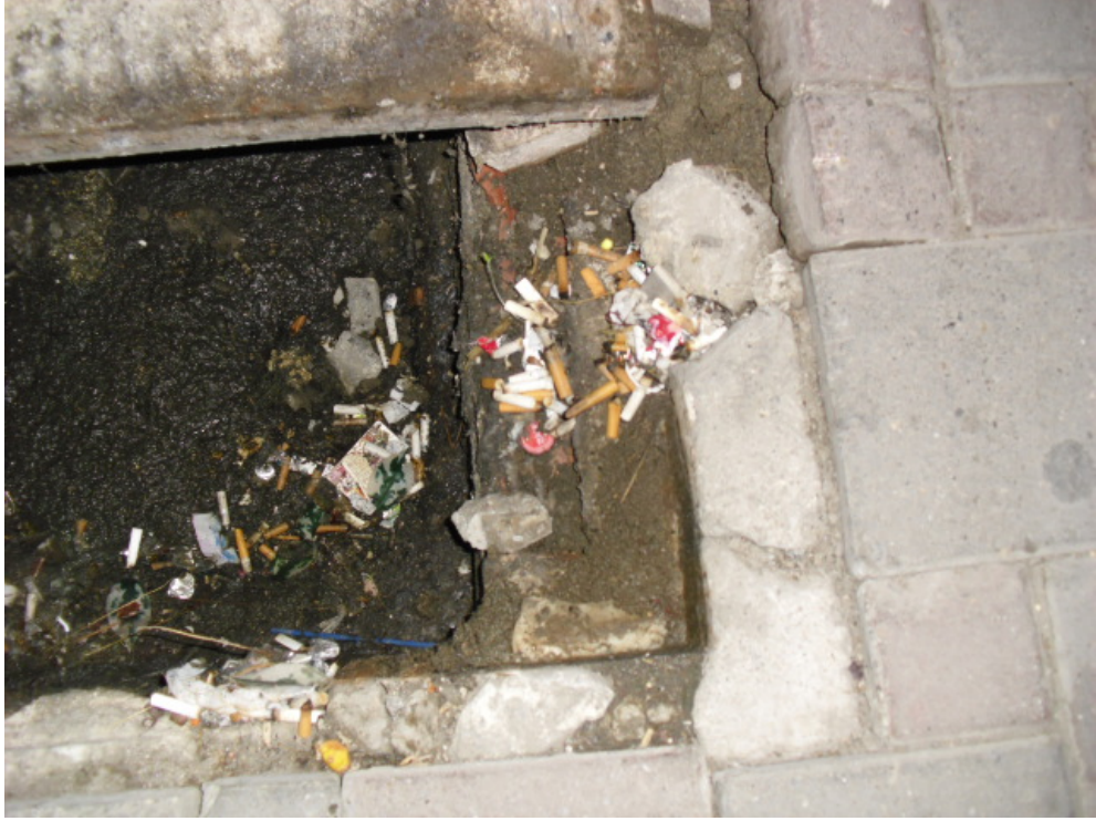
Şekil 4.2. Kanalizasyon sistemlerindeki ana kanal ve baca tıkanıklıklarına örnek
