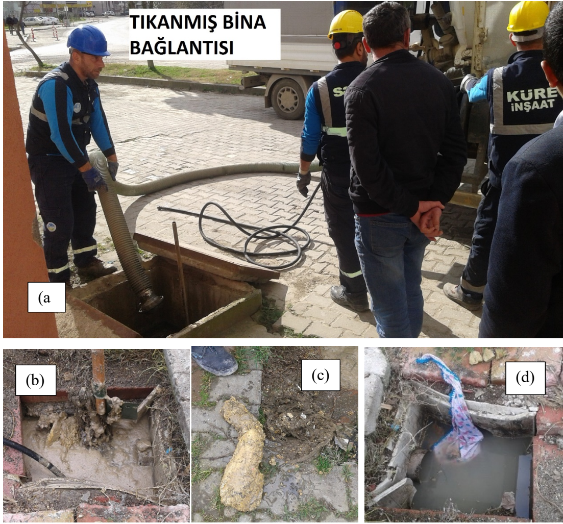
Şekil 4.3. Bina bağlantı bacalarına, ve bu bacalarda meydana gelen tıkanma olaylarının sebeplerine örnekler. (a) Parsel bacası, (b) Evlerden gelen atık yağların meydana getirdiği katı oluşumlar, (c) Yağların meydana getirdiği katı oluşumlar, (d) Bebek malzemelerinin hatalı şekilde bağlantı noktasında toplanması.
