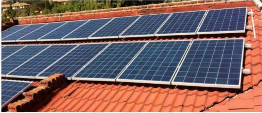
Şekil 4.5. Çatı üzeri kurulumu tamamlanmış güneş paneli dizimi
