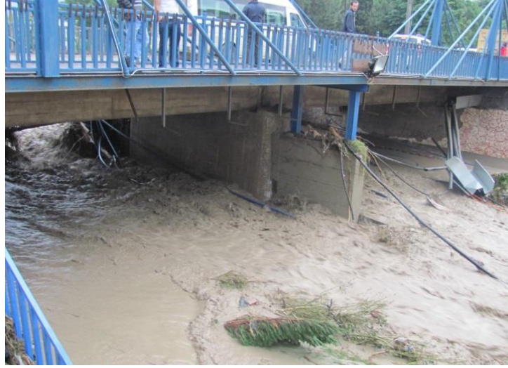
Şekil 5.7. Taşkın sonucu oyulan köprü ayakları [31].
