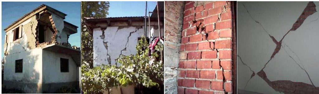
Şekil 3.3. Yığma yapıda oluşan duvar hasarları [26].
