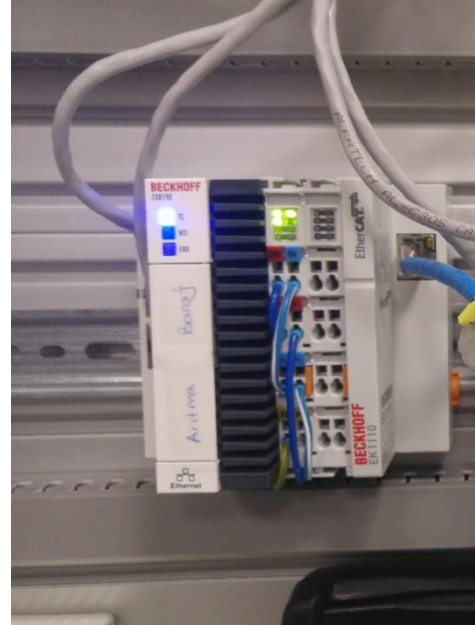
Şekil 3.6. PLC Yapılandırma moduna geçilmesi
