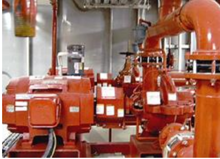
Şekil 2.32. Elektrikli yangın pompası 1.görseli
