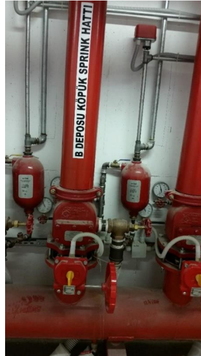
Şekil 2.3. Islak alarm vanasına ait 2.görsel
