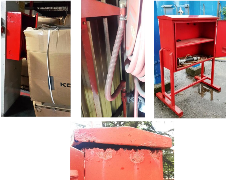
Şekil 2.46. Yangın ve hidrant ekipman dolapları
