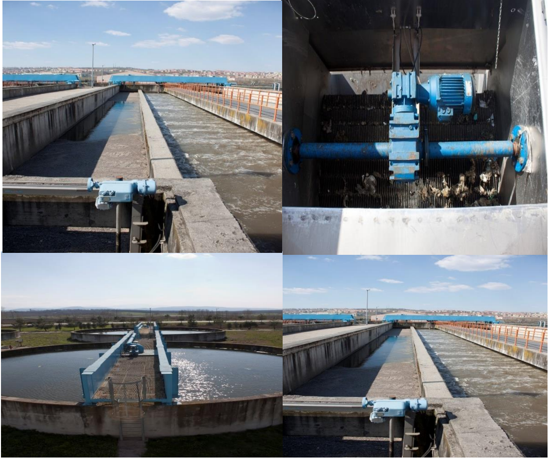
Şekil 5.2. Karaman atık su arıtma tesisi-2 [43]
