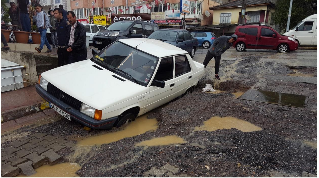
Şekil 5.4. Kaynarca ilçe merkezinden altyapı olmaması sebebiyle meydana gelen hasar
