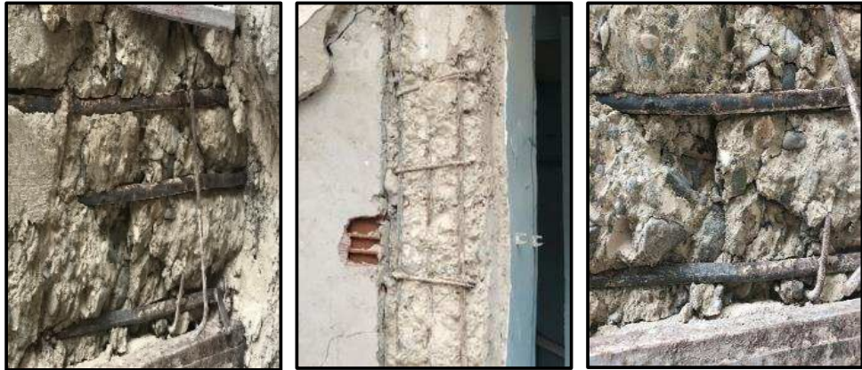
Şekil 1.1. Eski binalarda hasarlı betonarme kolonlar, düz donatı ve düşük enine donatı oranı (Caglar ve ark., 2021)
