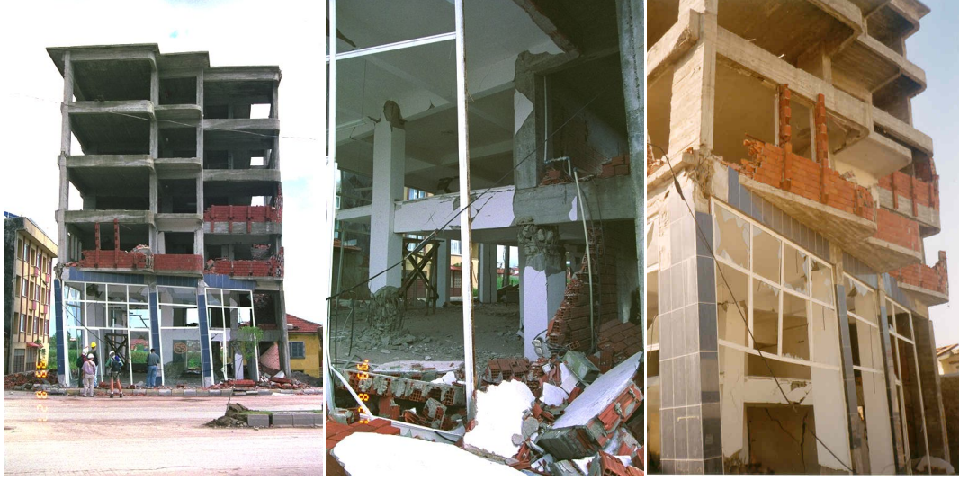
Şekil 6.19 Ekşioğlu Binası'nın Depremden Sonra Genel Görünüşü
