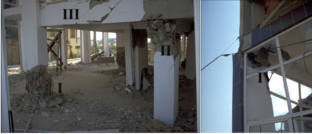
Şekil 6.20 Yapıdan hasar örnekleri
