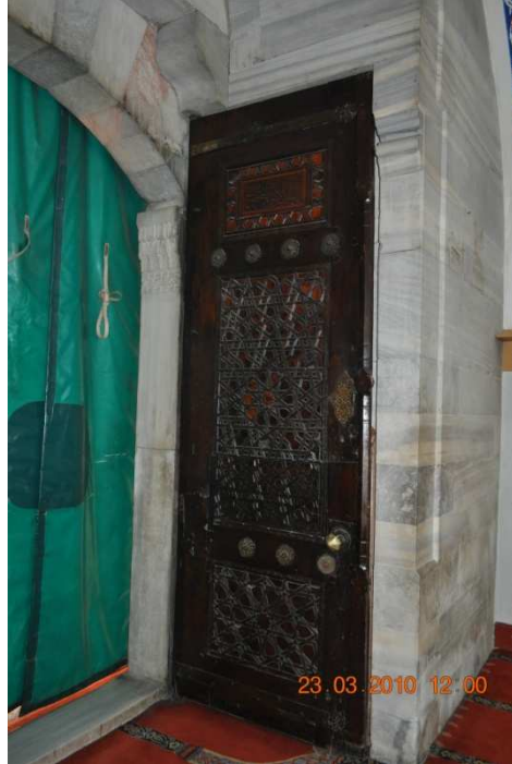
Resim 78: Ahřap Kapı Kanadı-Sol
