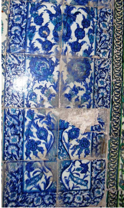
Resim 422: Şehzadeler Dairesi'nin devamı odaki içerisinde bulunan pano
