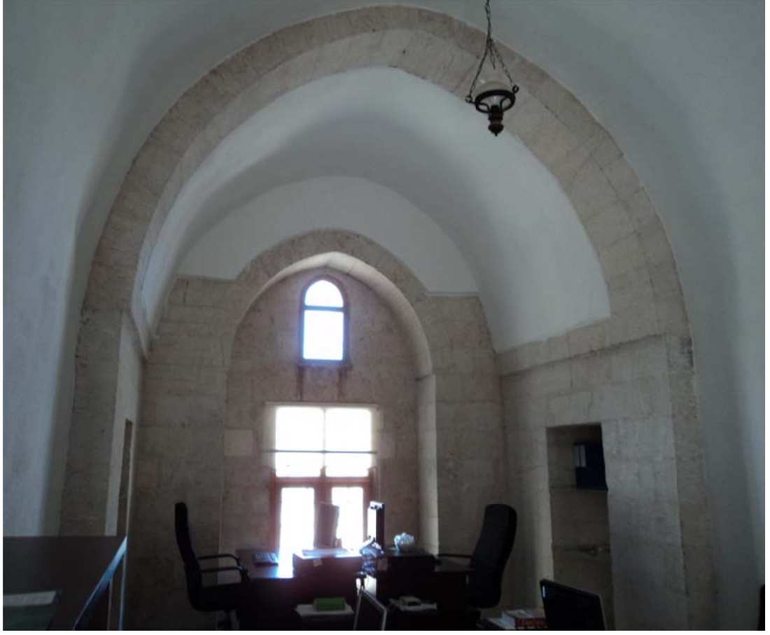
Fotoğraf 84: Medresenin Üst Kat Avlusunun Doğu Kanadının Güneyinde Yer Alan Odanın Kemerle Kademelenen Bölümü
