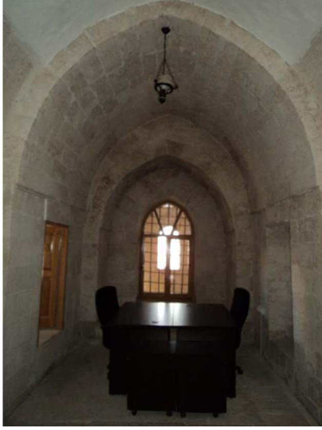
Fotoğraf 66: Üst Kat Türbe Mescidinin Kuzeyindeki Yıldız Tonozlu Bölümün, Güney Cephesindeki Beşik Tonozlu Alan
