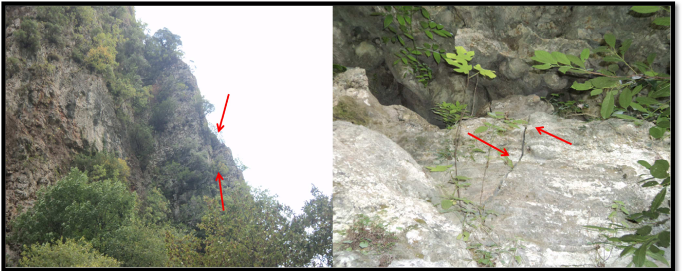
Foto 18: Kirazdere Kanyonun Dik Yamaçlarında Yer Alan Çatlak Sistemleri.
