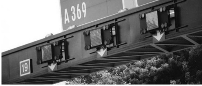
Şekil 5.3. Köprüye monteli vms'ler
