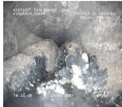
Beton Boru Tıkanması
