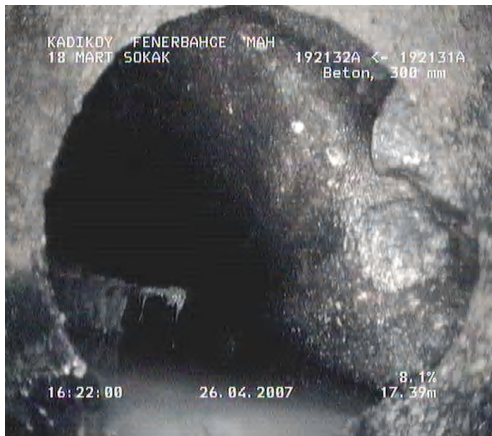
Beton Boru Kopması
