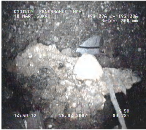
Beton Boruda Oluşan Yağ Sarkıtı
