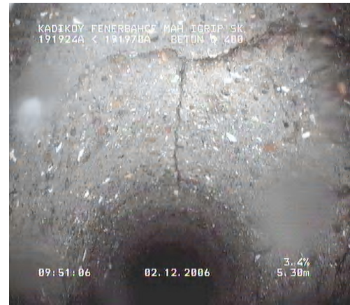
Beton Boruda Oluşan Çatlaklar
