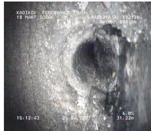
Beton Boru Çökmesi
