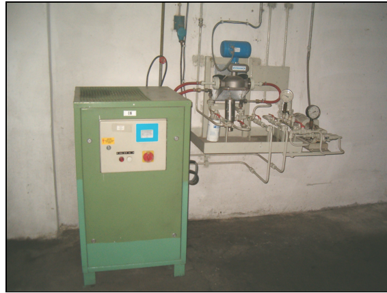
Resim 4.12. Kabin içi yakıt soğutma sistemi
