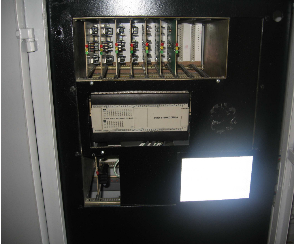
Şekil 3.2. PLC ile çalışan sinyalizasyon panosu
