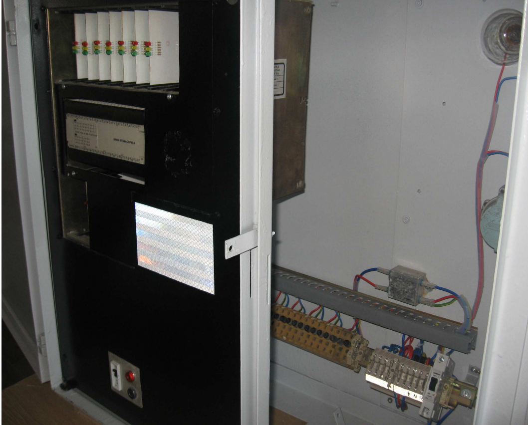
Şekil 3.1. PLC ile çalışan sinyalizasyon panosu
