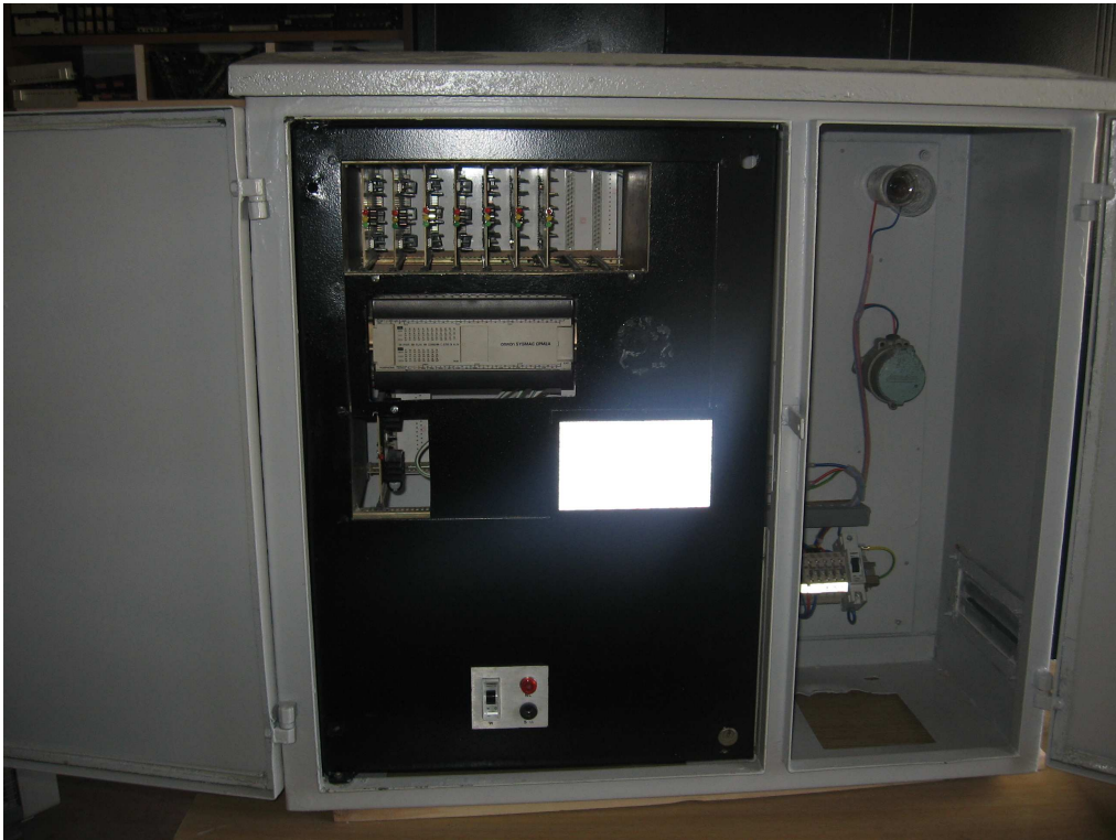
Şekil 3.3. PLC ile çalışan sinyalizasyon panosu
