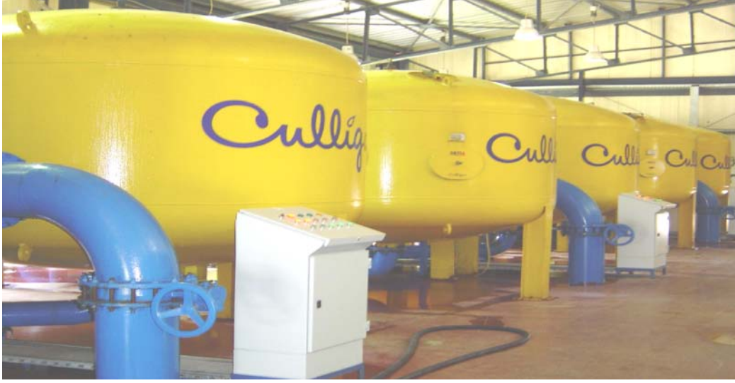
Şekil 5.3. Maltepe İçmesuyu Arıtma Tesisi hızlı kum filtreleri
