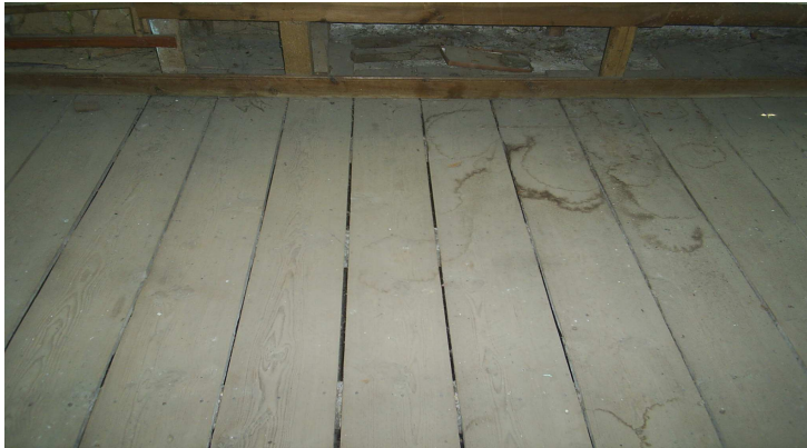
Şekil 6.4. Odanın restorasyon öncesi ahşap yer döşemesi
