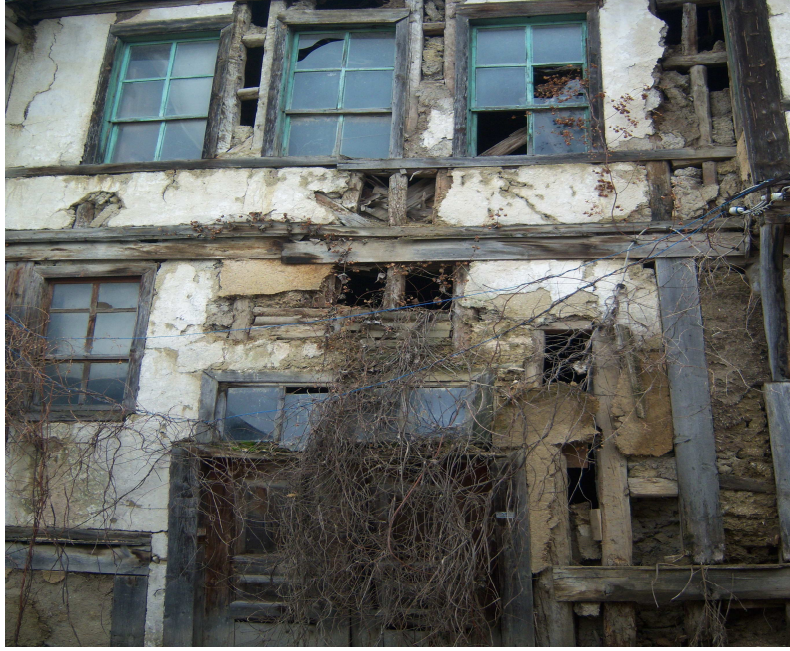
Şekil 4.22. Kötü durumda olan yapı örneği
