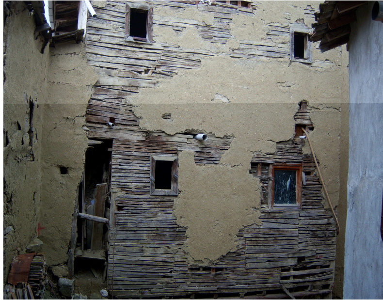
Şekil 4.23. Kötü durumda olan yapı örneği
