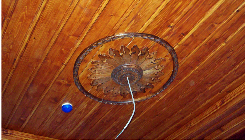
Şekil 6.5. Restorasyon öncesi ahşap tavan döşemesi
