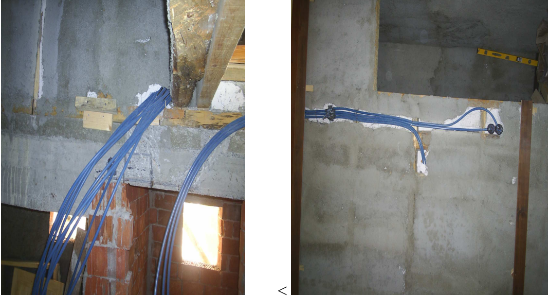
Şekil 6.31. Elektrik tesisat kablolarının görünüşleri
