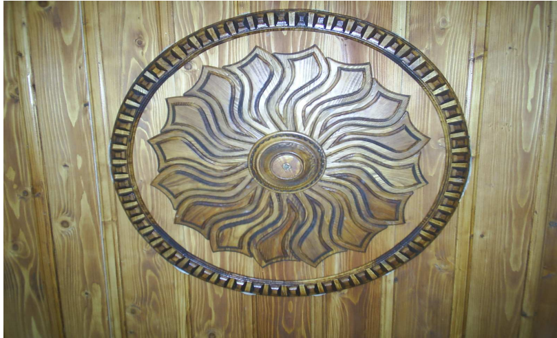
Şekil 6.6. Restorasyon öncesi ahşap tavan döşemesi
