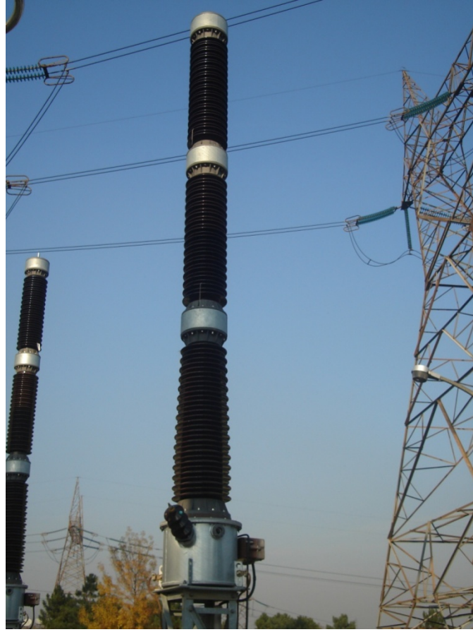
Şekil 2.17 380kV kapasitif gerilim trafosu
