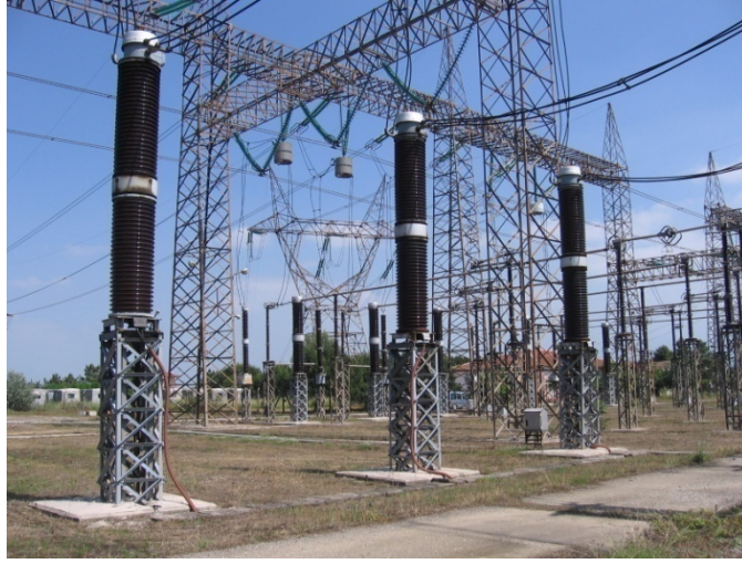
Şekil 2.4 380 kV harici akım trafoları
