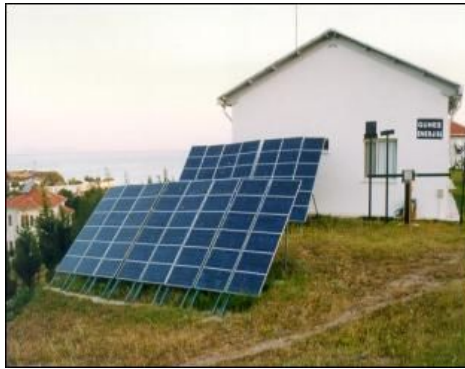
Resim 4.2. Şebeke Bağlantılı 4,8 kW Güneş Pili Sistemi
