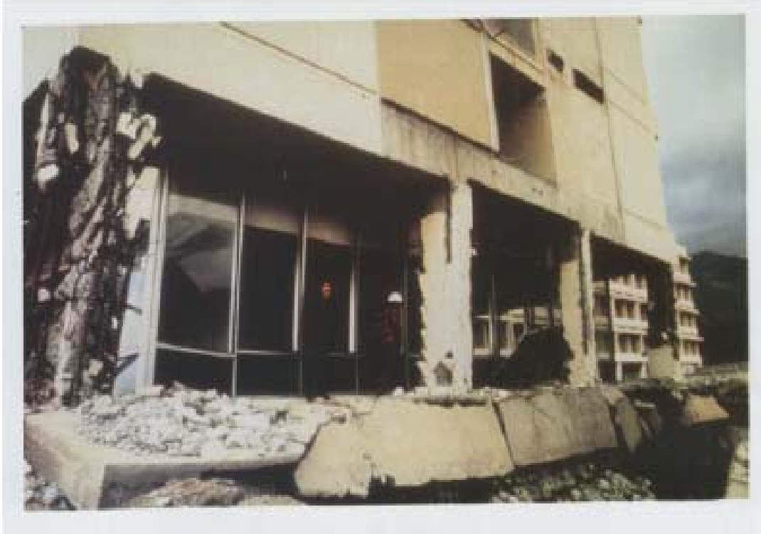
Şekil 2.11. Olive View Hastanesi zayıf kat hasarı
