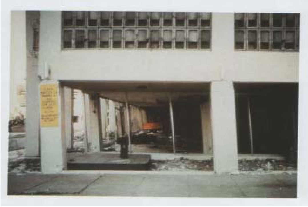
Şekil 2.12. Casa Micasa Binası zayıf kat hasarı
