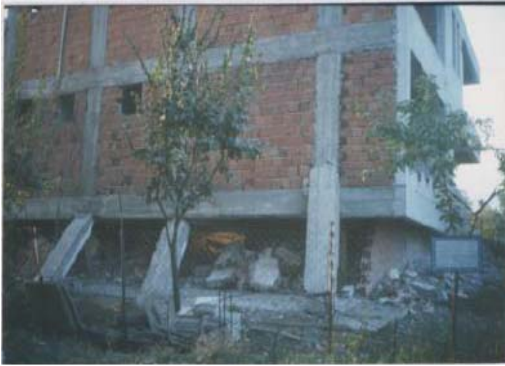
Şekil 3.1. Gölçük-Körfez Yukarı Mahalle’de zayıf kat hasarı
