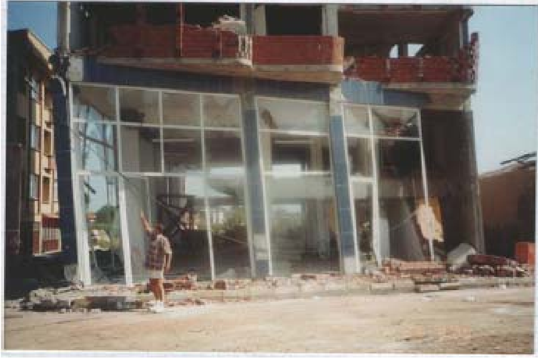
Şekil 2.15. Adapazarı’nda 5-katlı binanın zayıf katında ağır hasar
