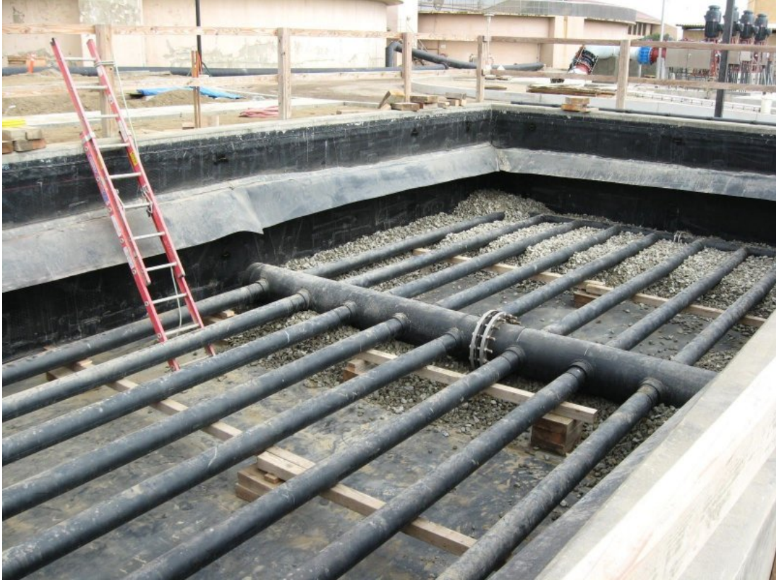
Şekil 1.5 Arıtma tesislerinde kullanılan biyofiltre [3]
