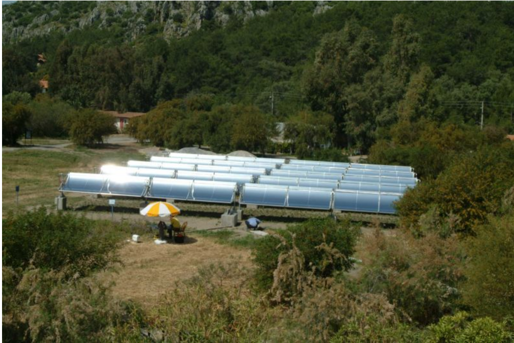
Şekil 2.3 Güneş enerjisi tesisi [6]
