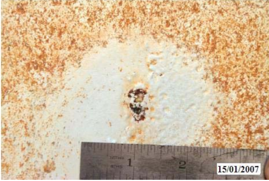
Şekil 3. 15. Tank sacında korozyon
