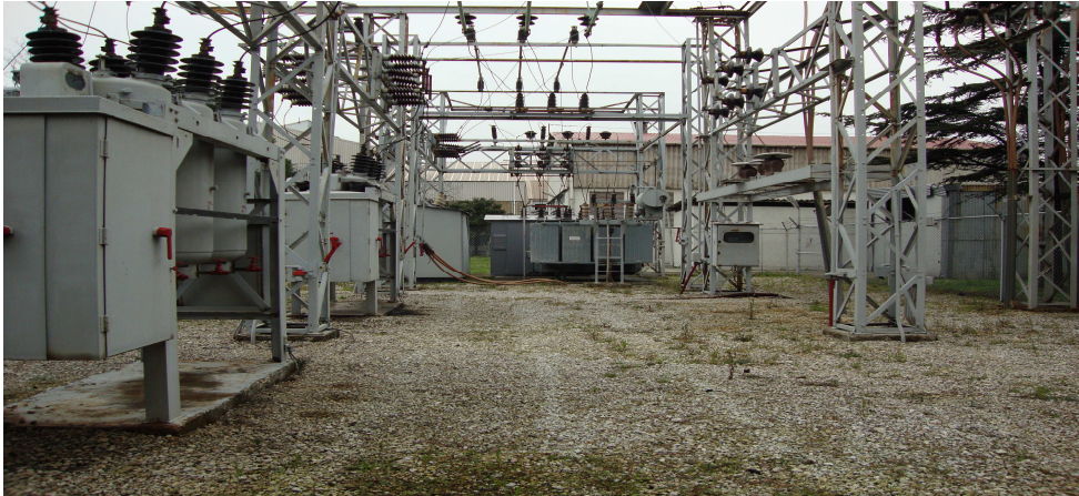
Şekil 6.2. Sahil elektrik santrali şalt sahası resmi
