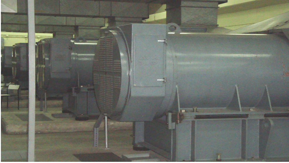
Şekil 6.1. Bir sahil elektrik santralindeki dinamik frekans konvertörlerine ait resim
