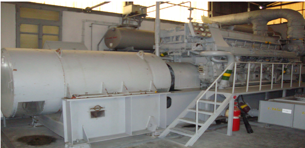
Şekil 6.4. Sahil elektrik santrali orta gerilim jeneratörleri
