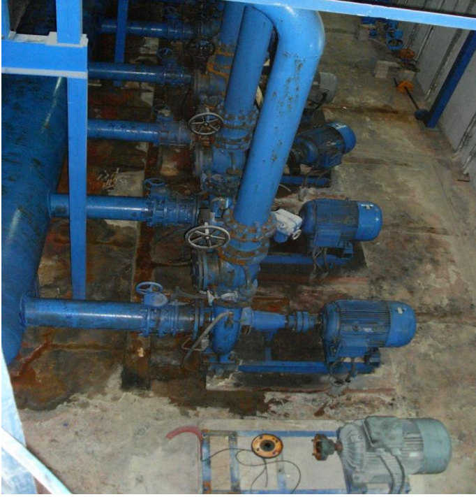
Şekil 4.1. Adasu Maltepe tesisi pompa istasyonu
