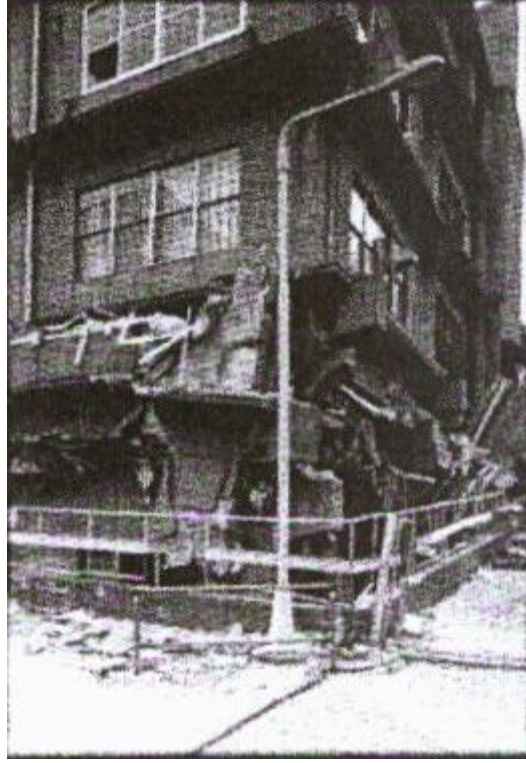
Şekil 2.5. Cephede Çıkma Yapan Binada Hasar, Kobe, 1995
