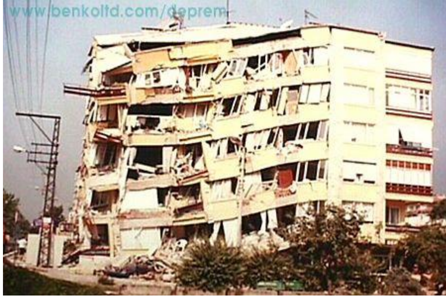
Şekil 3.4 Bina Köşelerinde Ağır Hasar, Yalova, 1999
