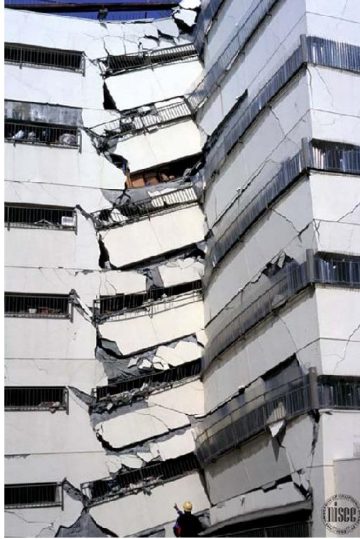
Şekil 3.3. Binanın Kollar Birleşiminde Hasar, Kobe,1995.
