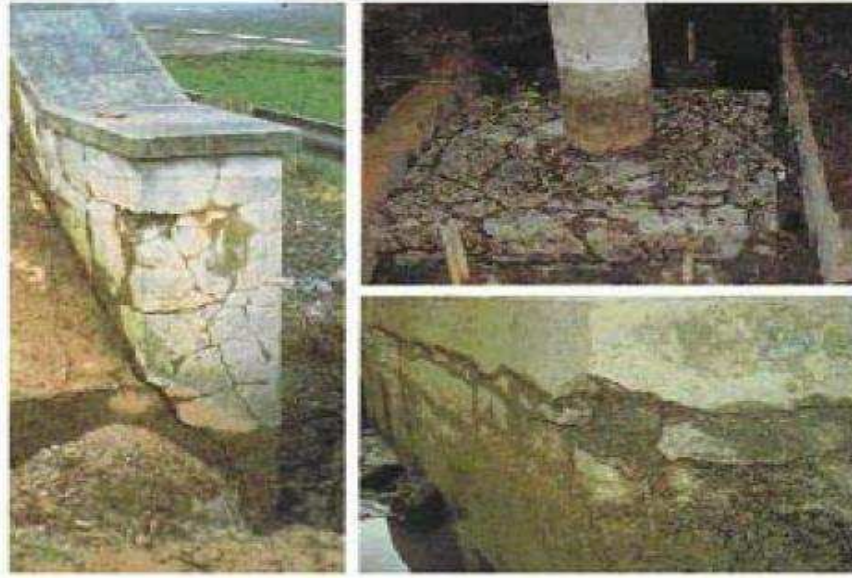
Şekil 3.14. ASR' den kaynaklanan çatlaklara ilişkin görüntüler
