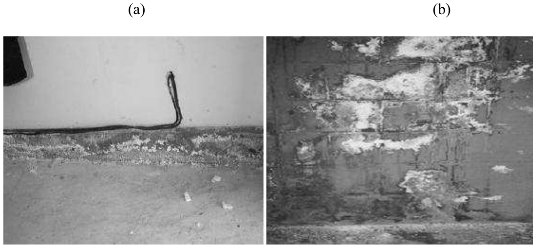
Şekil 3.3. Tuz kristalizasyonunun buharlaşma ile ortaya çıkışı; a) duvarın tabandan nem alması ve nemin taşıdığı tuzların yüzeyde suyun buharlaşması sonucu birikimi, b) İstinat duvarının arkasından nemin taşıdığı tuzların ön tarafta suyun buharlaşması sonucu birikimi.
