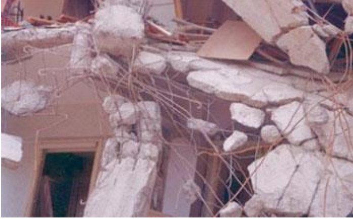
Şekil 3.15. Yetersiz malzeme kalitesi sebebiyle betonları dağılarak ağır hasar gören bir yapı
