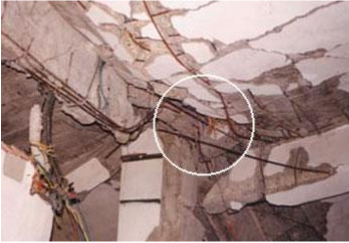
Şekil 3.19. Kolon-kiriş birleşimindeki donatı yetersizliği sebebiyle kirişin koparak ayrılması
