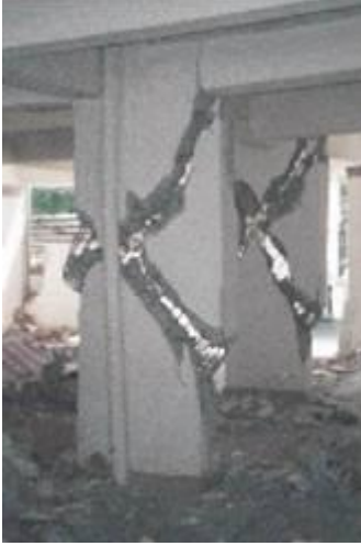
Şekil 3.16. Marmara Depremi sonrasında Düzce’ de yetersiz donatı ve kalitesi düşük beton kullanımı sonucunda oluşmuş kolon hasarı
