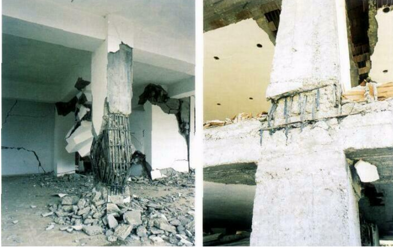
Şekil 3.18. Kolonda basınç kırılması, yetersiz donatı düzeni ve kolon-kiriş birleşim bölgesinde uygun olmayan donatı düzeni
