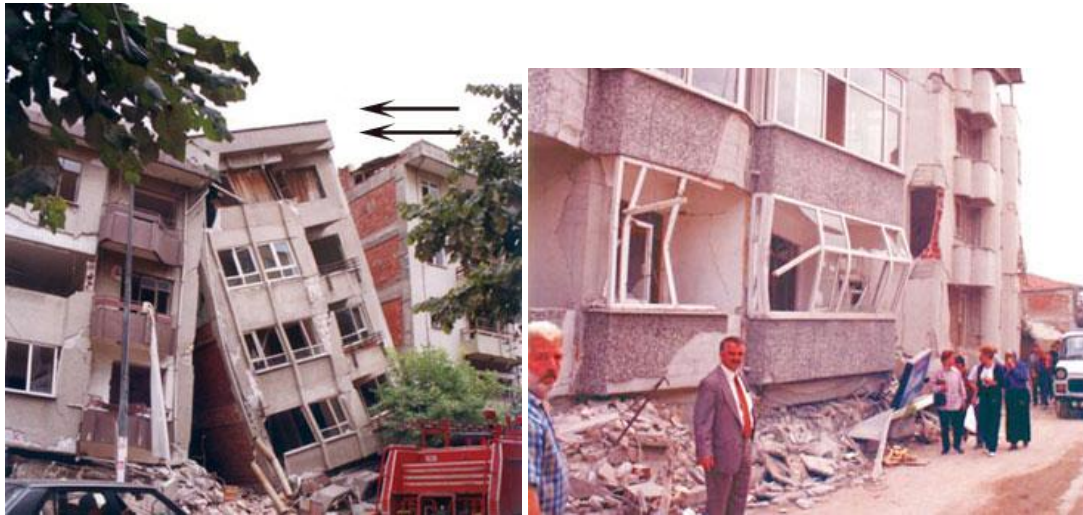
Şekil 3.22. Zemin katları ticari amaçla kullanılan yapılarda yumuşak kat oluşumuna örnek
