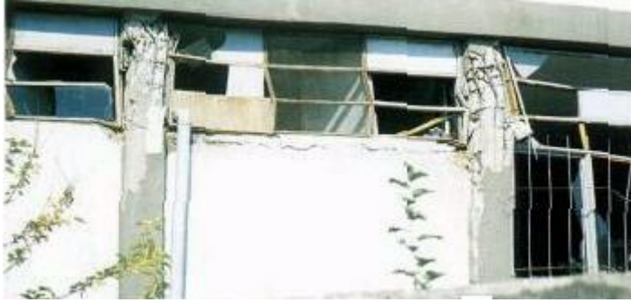
Şekil 3.20. Bant pencere nedeniyle kısa kolon hasarı
