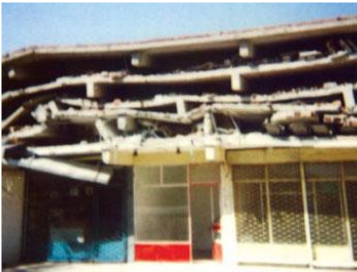
Şekil 3.21. Zayıf kolon-güçlü kiriş, yetersiz donatı ve yetersiz kesit sebebiyle göçen bina
