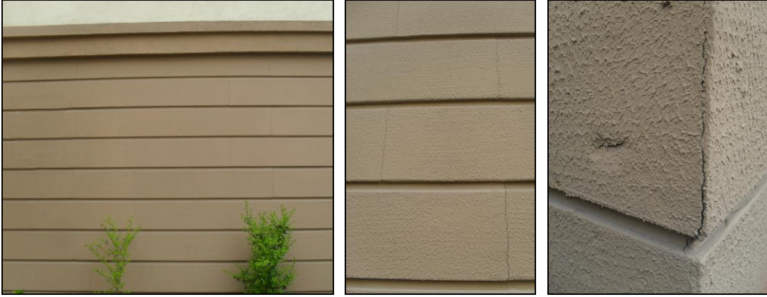
Şekil 5.27. Yüzey dokulu poliüretan malzemelerde görülen sorunlar
