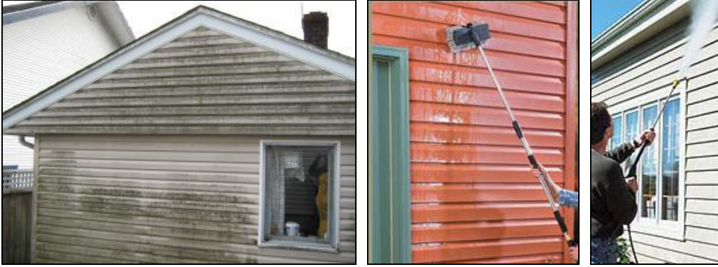
Şekil 5.26. Vinil siding kaplama kirlenmesi ve temizlenmesi örnekleri
