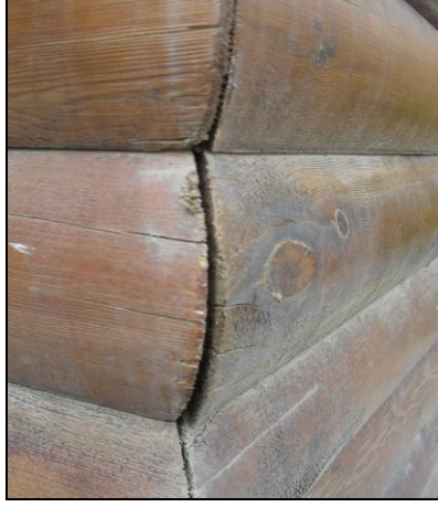
Şekil 5.13. Ahşap cephe kaplamalarda görülen açılmalara örnek
