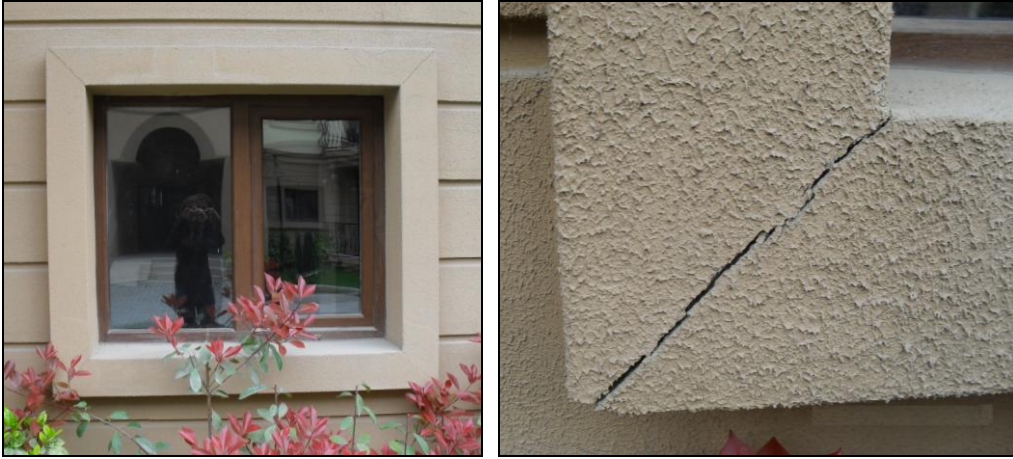
Şekil 5.28. Yüzey dokulu poliüretan söve elemanında görülen açılma örneği
