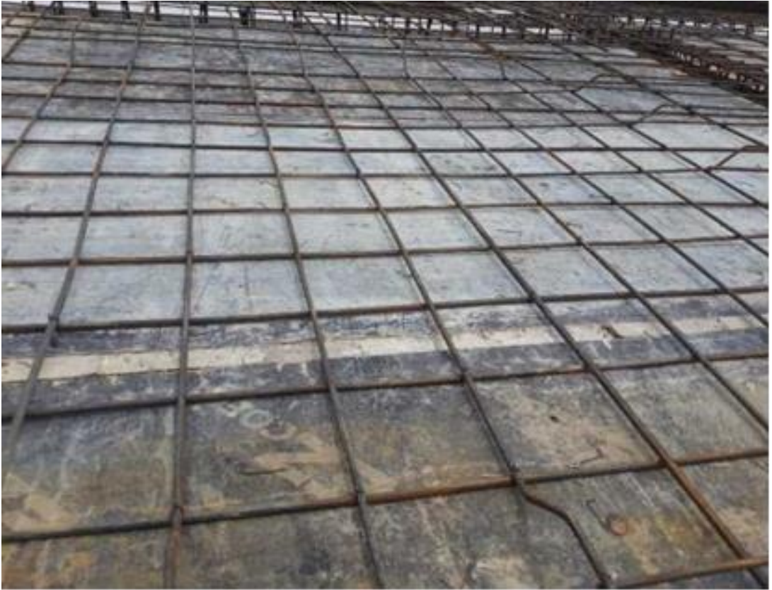
Şekil 4.21. Tek doğrultulu çalışan kirişli döşemelerde dağıtma donatısı ile ilgili şartlara uyulmaması durumu
