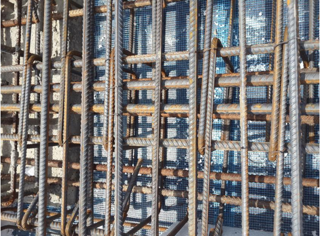
Şekil 4.17. Kirişlerde net beton örtüsü şartına uyulmaması durumu
