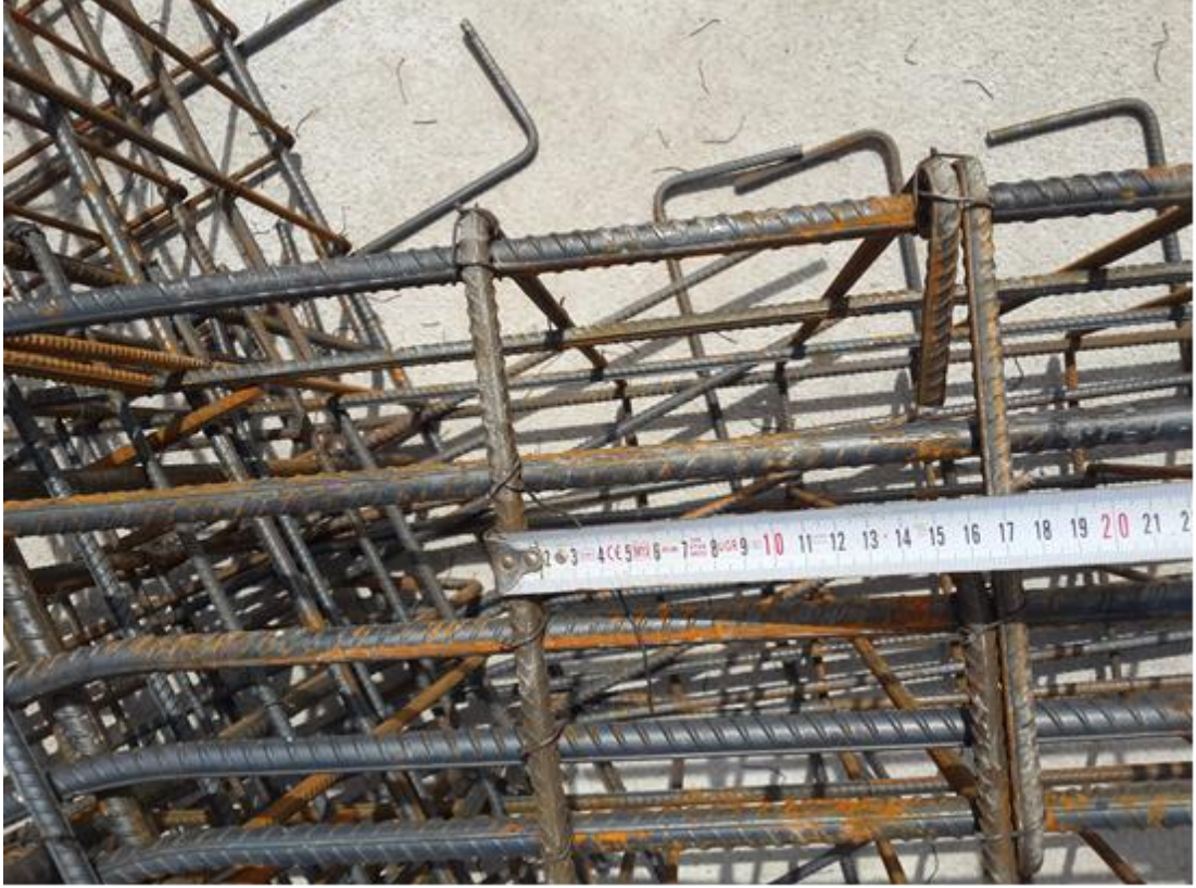
Şekil 4.15. Kirişlerde sarılma bölgelerindeki enine donatı aralığı şartına uyulmaması
