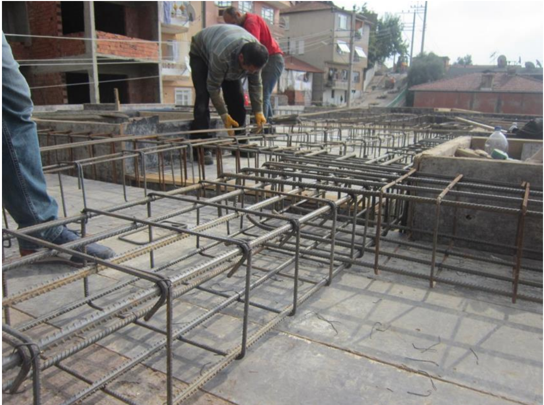
Şekil 4.3. Enine donatı kanca açısının 135 derece yapılmaması
