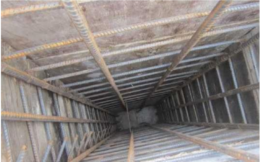
Şekil 4.8. Kolonlarda sarılma ve orta bölgelerde enine donatı şartına uyulmaması
