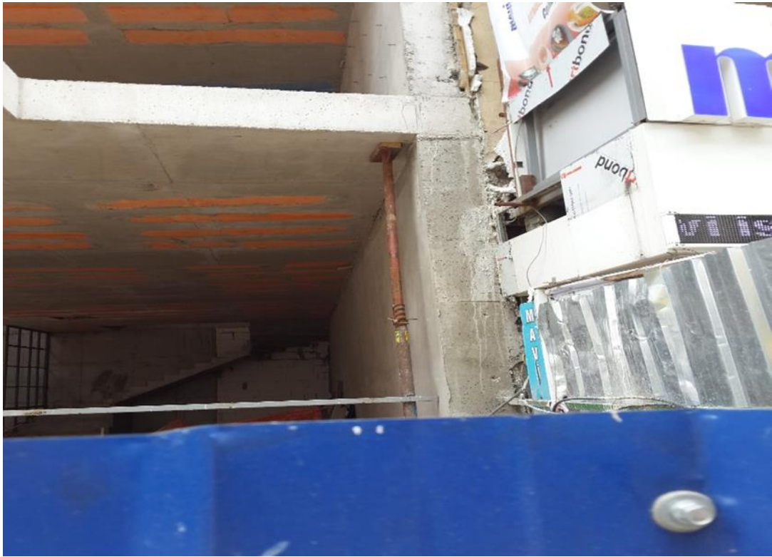
Şekil 4.4. Dilatasyon derzi şartına uyulmaması
