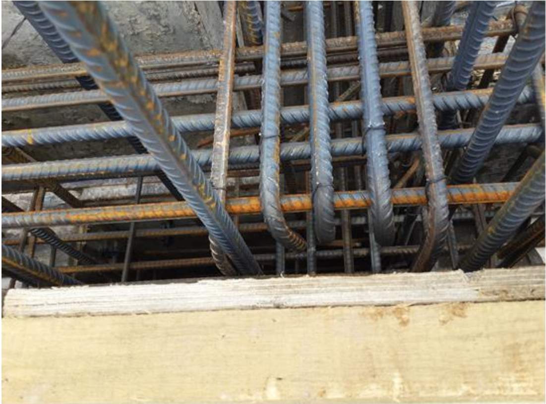
Şekil 4.14. Kenar kolona birleşen kiriş boyuna donatı çubuklarının kanca boyu şartına uyulmaması durumu
