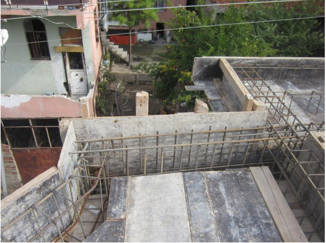
Şekil 4.13. Kirişlerin donatılarının kolon içerisine 90 derece bükülmemesi durumu
