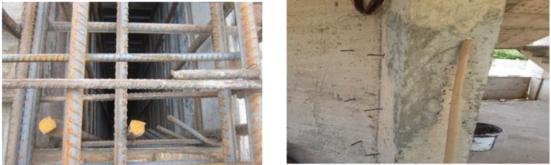
Şekil 4.7. Kolonlarda net beton örtüsü şartına uyulmaması
