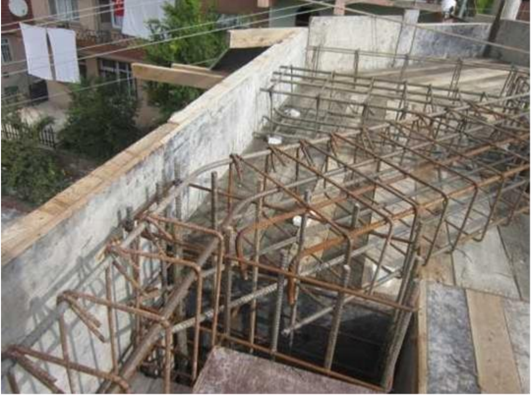
Şekil 4.10. Kolon bindirme boyu şartın uyulmaması
