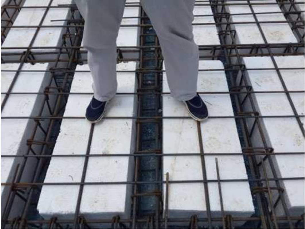
Şekil 4.22. Dişli döşemelerde dağıtma donatısı ile ilgili şartlara uyulmaması durumu
