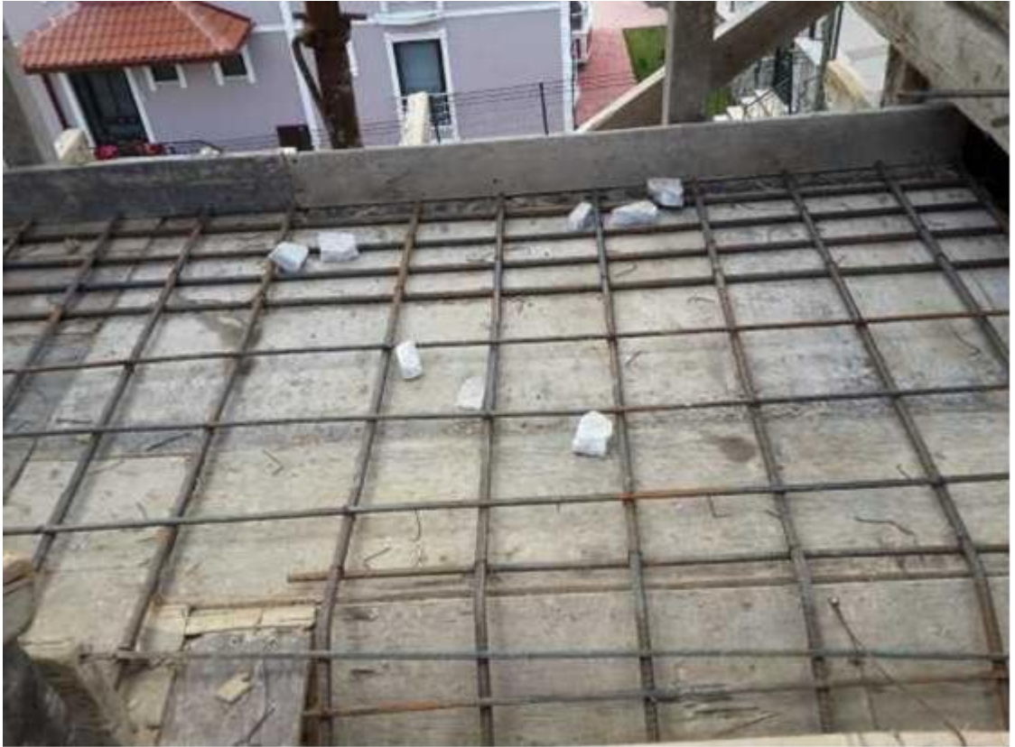
Şekil 4.20. Döşemelerde net beton örtüsü şartına uyulmaması durumu
