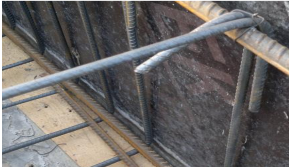
Şekil 5.40. Kirişlerde net beton örtüsü şartına uyulmaması
