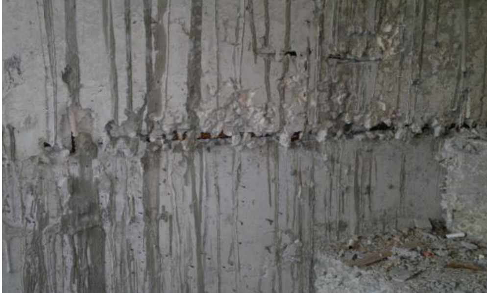
Şekil 5.11. Soğuk derz durumuna uyulmaması
