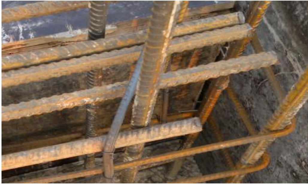
Şekil 5.34. Kirişlerde boyuna donatının 90 derece kıvrılması şartına uyulmaması
