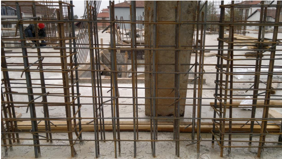
Şekil 5.67. Betonarme perdelerde çiroz kullanılmasına uyulmaması durumu
