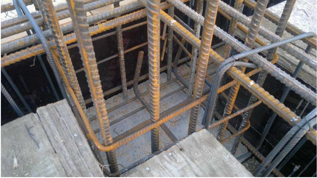
Şekil 5.42. Kolon-kiriş birleşim bölgelerinde enine donatı ile ilgili verilen şartlara uyulmaması durumu
