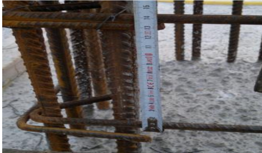
Şekil 5.21. Sarılma ve orta bölgede enine donatı aralığı kuralına uyulmaması
