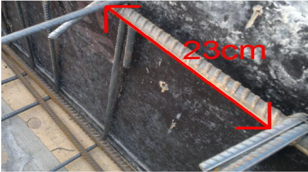
Şekil 5.38. Kirişlerde enine donatı aralığı şartına uyulmaması
