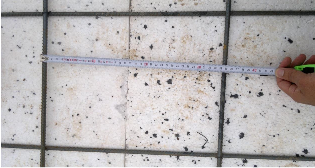
Şekil 5.51. Dişli döşemelerde dağıtma donatısı aralığı ile ilgili şartta uyulmaması durumu
