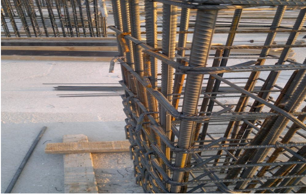
Şekil 5.6. Kanca açısının 135 derece olmaması durumu
