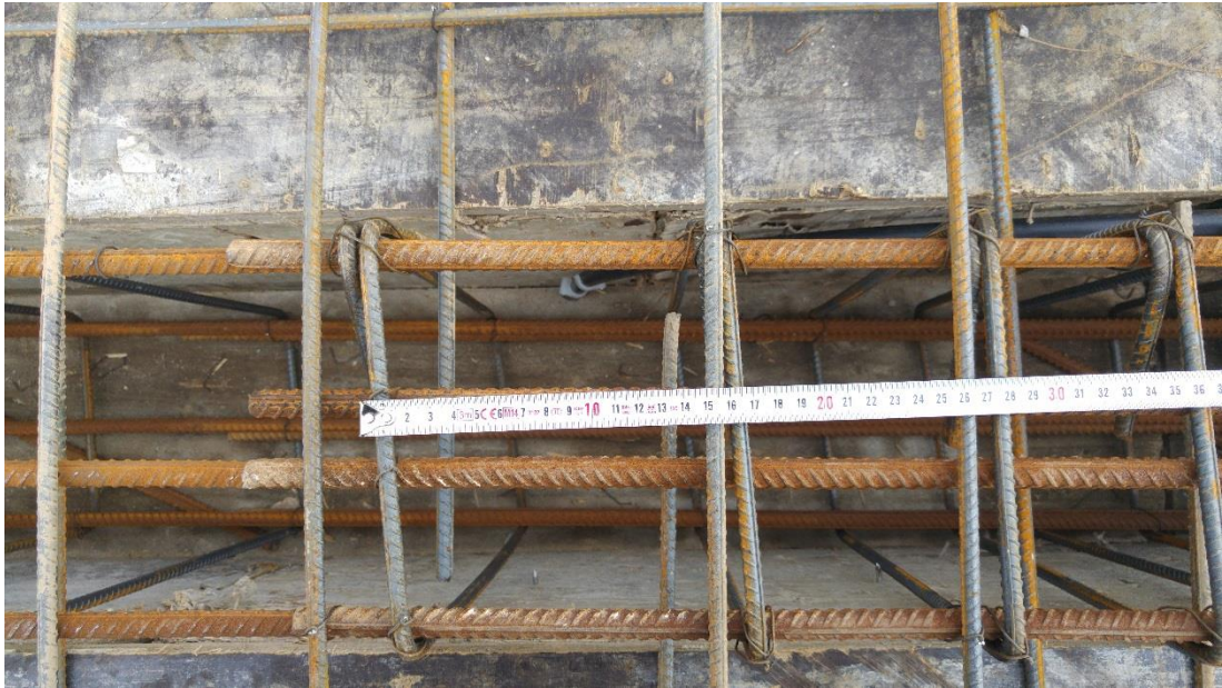
Şekil 5.4. Bindirmeli eklerde sargı donatısı koşullarına uygulamada uyulmaması durumu
