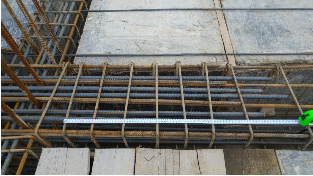
Şekil 5.30. Kirişlerde boyuna donatı çubukları arasındaki mesafe şartına uyulmaması
