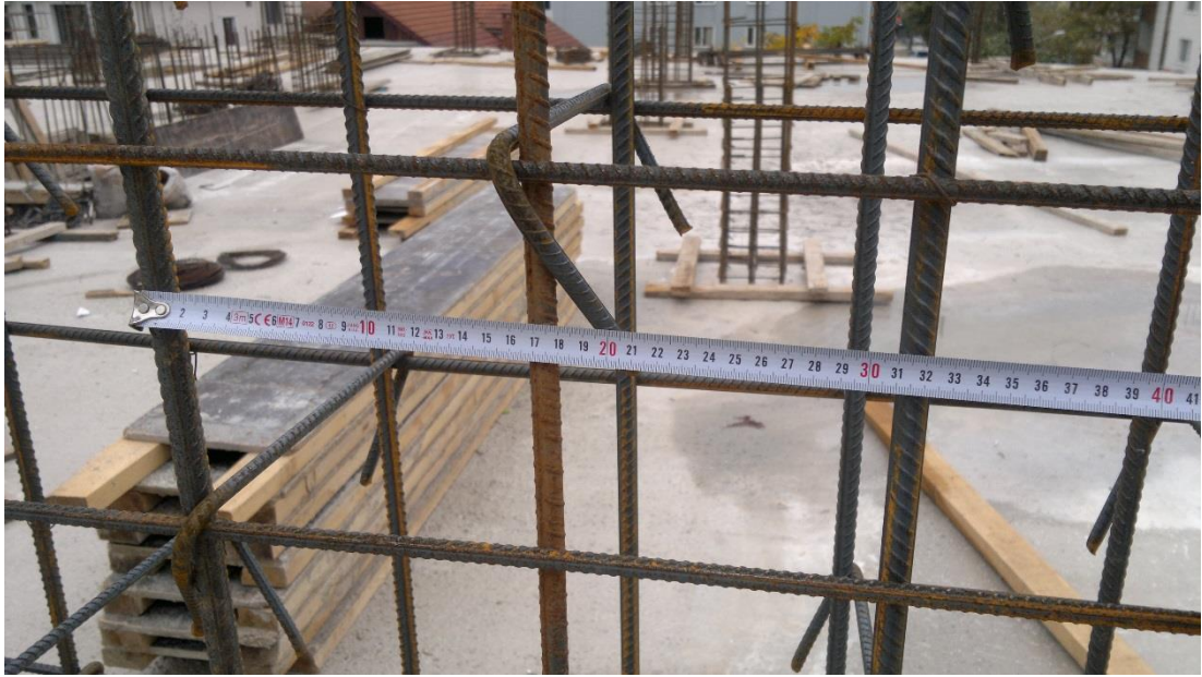
Şekil 5.62. Betonarme perdelerde düşey gövde donatısı aralığı ile ilgili verilen şartta uyulması durumu
