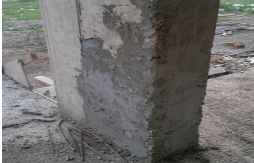
Şekil 5.14. Kolonlarda net beton örtüsü şartına uyulmaması
