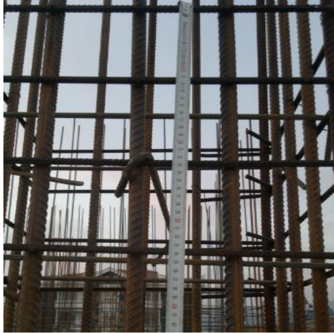
Şekil 5.18. Sarılma bölgesi uzunluğu şartına uyulmaması
