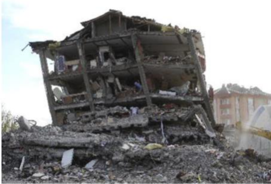
Şekil 4.1. Erciş depreminde hasar görmüş bir asmolen yapı
