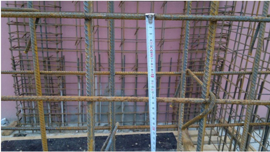
Şekil 5.61. Betonarme perdelerde yatay gövde donatısı aralığı ile ilgili verilen şarta uyulması durumu
