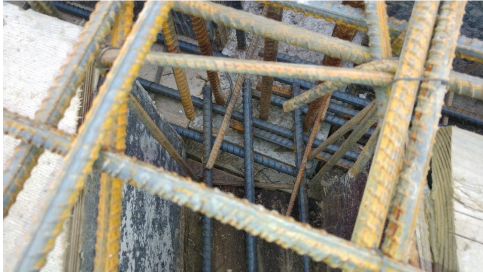
Şekil 5.36. Kirişlerde kenetlenme boyu şartına uyulmaması
