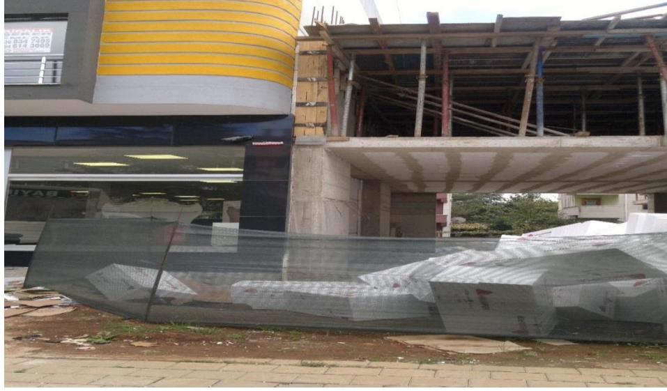
Şekil 5.8. Dilatasyon derzi şartına uyulmaması
