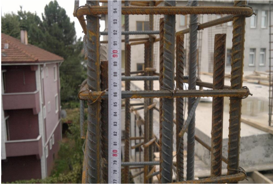
Şekil 5.23. Bindirme boyu şartına uyulmaması
