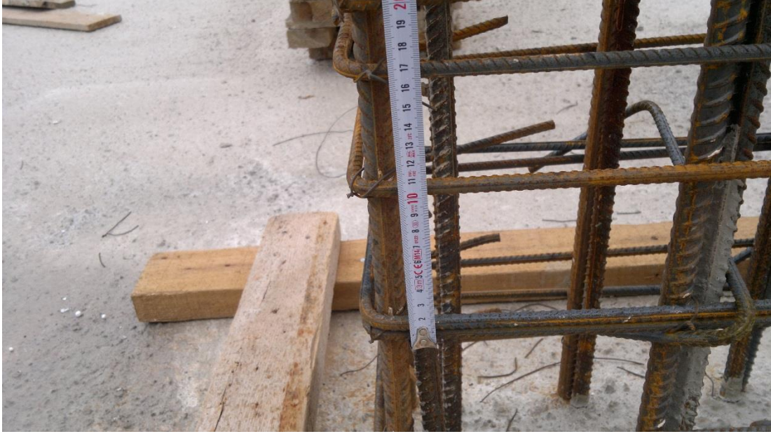
Şekil 5.65. Perde uç bölgesindeki enine donatı aralığı ile ilgili verilen şartlara uyulmaması durumu
