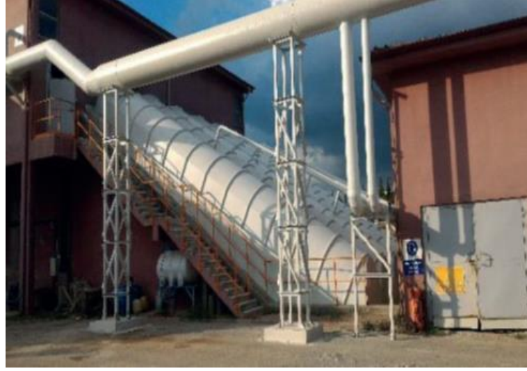
Şekil 1.2. Karaman AAT Giriş Terfi İstasyonu
