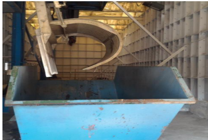
Şekil 1.1. Karaman AAT Kaba Izgara Ünitesi
