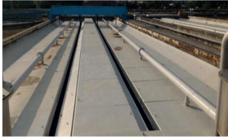
Şekil 1.5. Havalandırmalı Kum ve Yağ Tutucu Ünitesi
