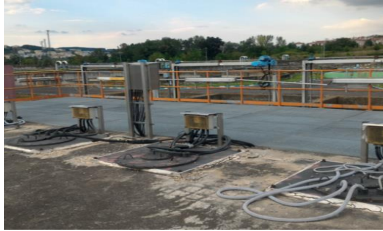
Şekil 1.8. Karaman AAT Geri Devir İstasyonu
