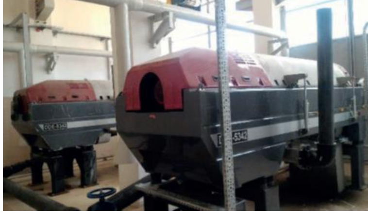
Şekil 1.10. Karaman AAT Mekanik Susuzlaştırma Ünitesi
