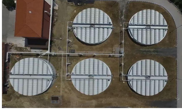
Şekil 2.5. Üzeri Kapatılan Çamur Yoğunlaştırma Havuzları
