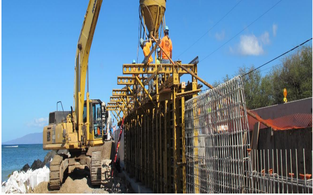
Şekil 2.9. Deniz yakını yapılarda FRP kullanım örnekleri [92]
