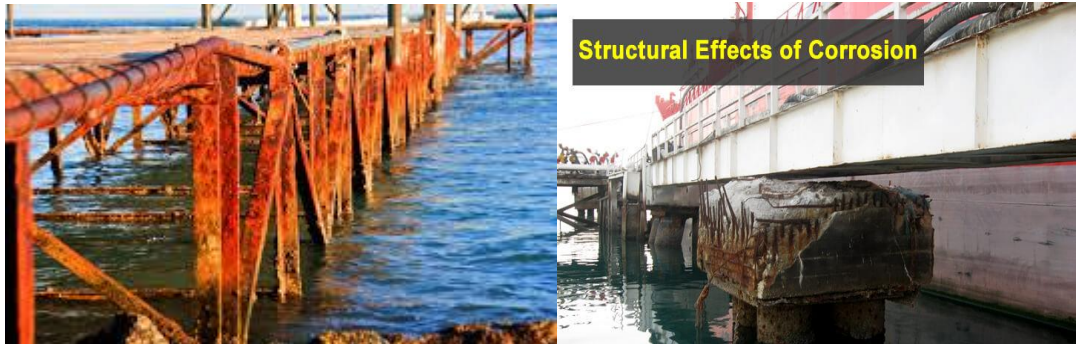
Şekil 2.8. Korozyona uğramış deniz yapıları [25]
