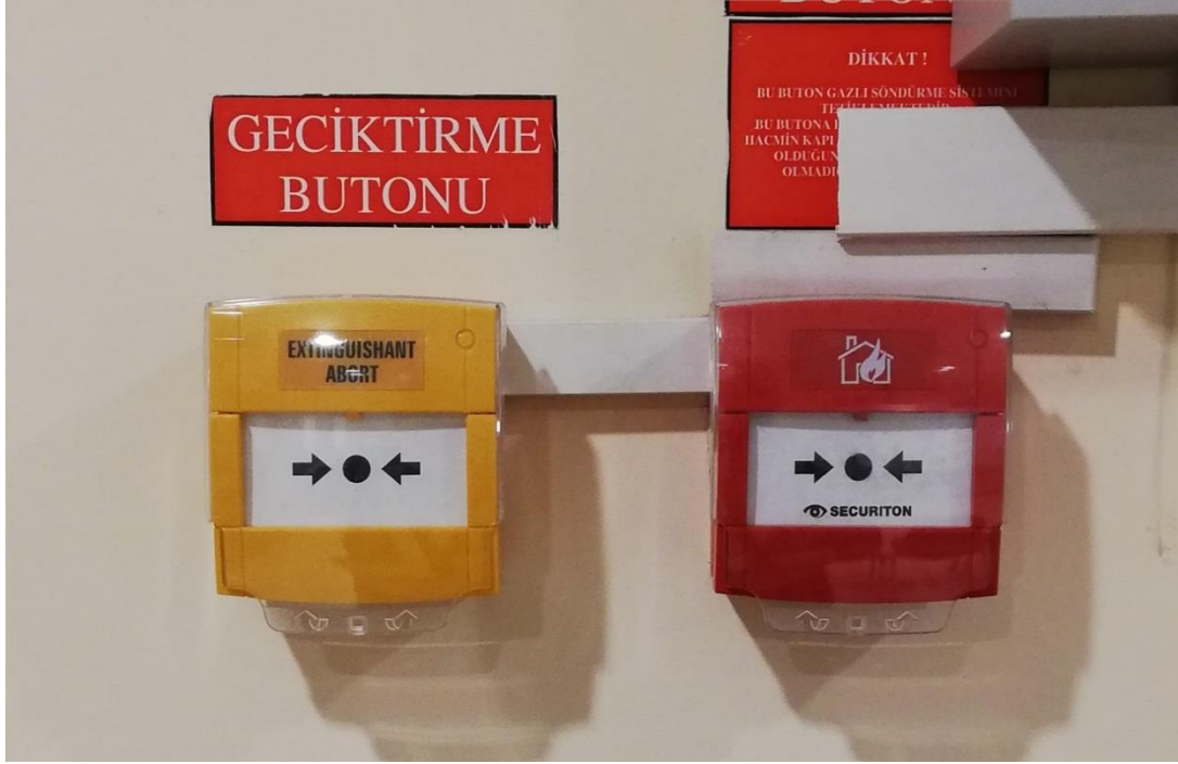
Şekil 5.8. Model otomotiv sanayisinde yangın alarm butonu ve yangın sistemini geciktirme butonu
