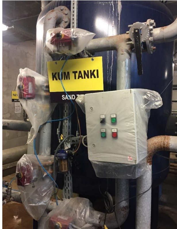
Şekil 6.4. Yumusatma tesis kum tankı ünitesi
