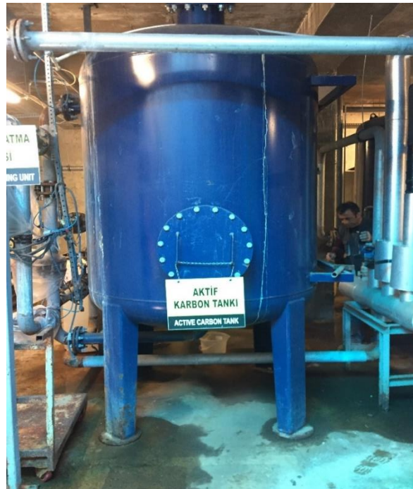
Şekil 6.5. Yumusatma tesisi aktif karbon tankı
