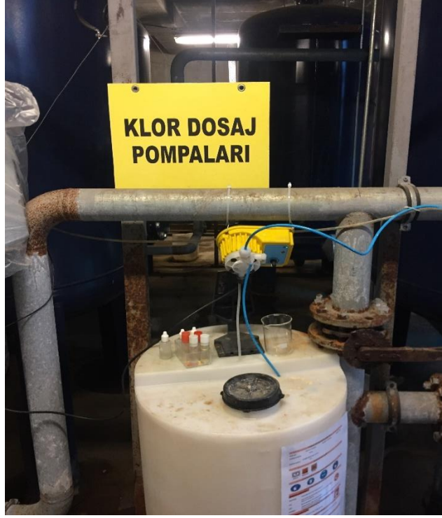
Şekil 6.6. Klorlama ünitesi (klor dozaj pompası).
