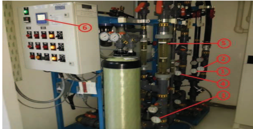
Şekil 4.1. Soğutma suyu göstergeleri
