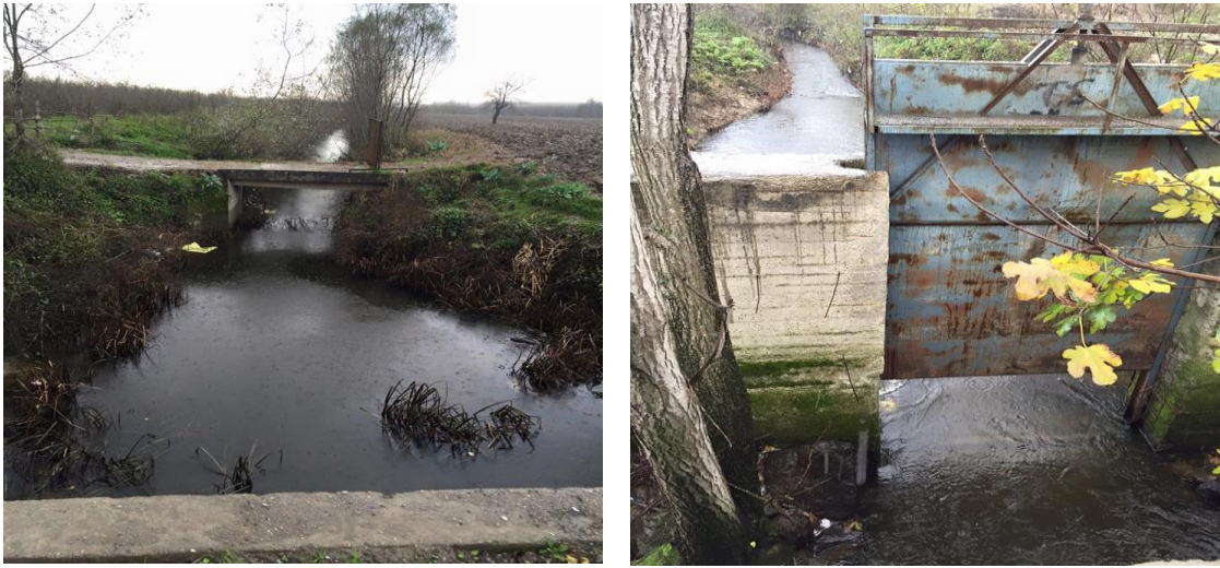
Şekil 3.5. Konacık Kanalı ve Tahliye Kapağı
