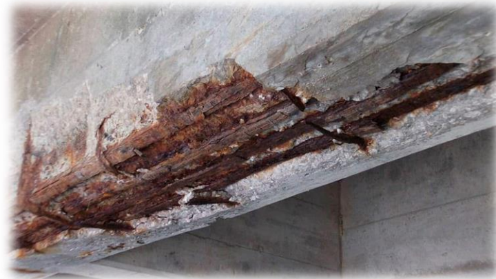
Şekil 1.3. Betonarme kirişin korozyonu (Namita, 2018)
