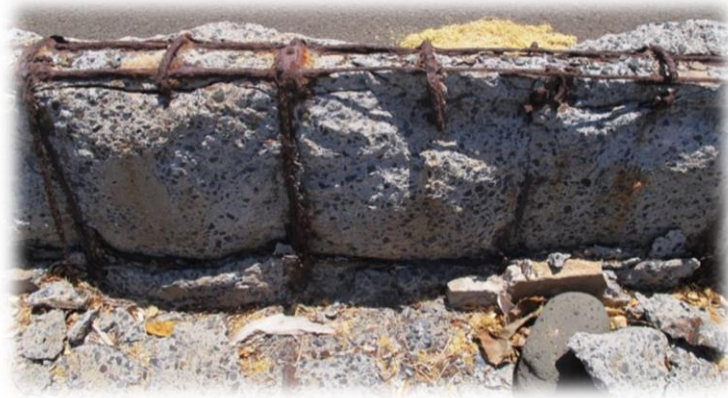
Şekil 1.2. Korozyon sebebiyle özelliğini yitiren bordür (Sarıbyık ve ark., 2018)
