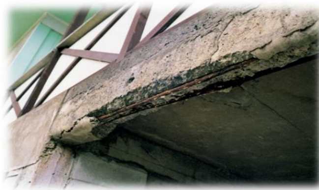
Şekil 1.1. Korozyon nedeniyle betonun paspayı düşmesi ve donatıları paslanması (Foundation masters, 2004)
