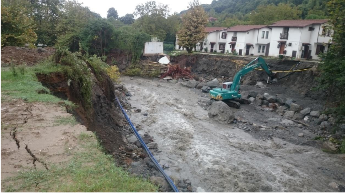
Şekil 5.22. Mahmudiye Deresinde taşkınlardan sonra oluşan kıyı oyulması
