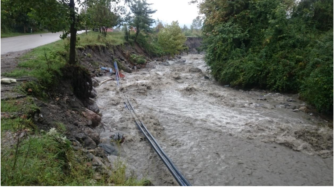
Şekil 5.24. Mahmudiye Deresinde yaşanan taşkın sonrası zarar gören altyapı tesisleri
