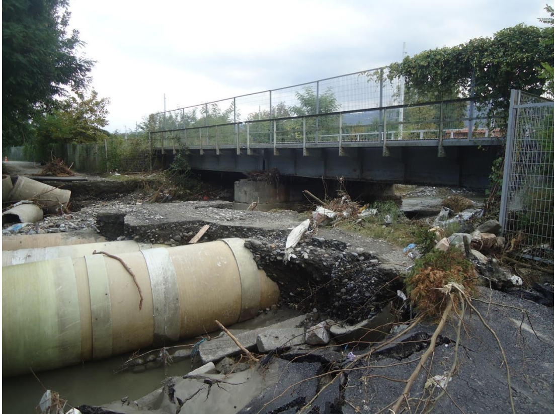
Şekil 5.19. Taşkın sonrası Kurtköy Deresinde meydana gelen taban erozyonu
