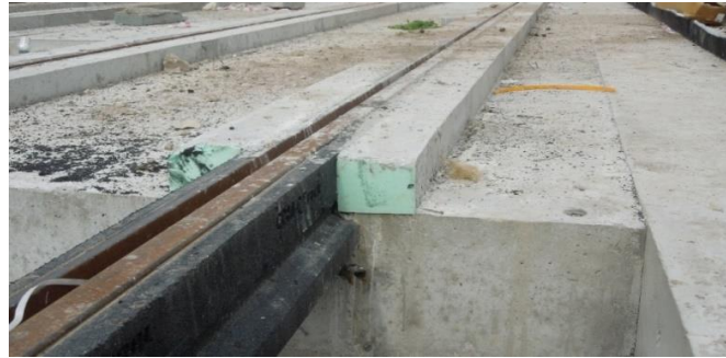
Şekil 3.28. Elastik yataklı ray bağlantı sistemi uygulaması
