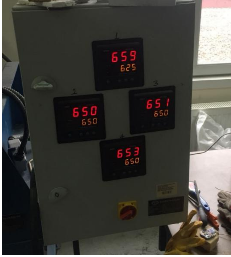
Şekil 3.10. Dört farklı tabakanın sıcaklık değerlerini gösteren PID sıcaklık kontrol cihazlarını içeren kontrol paneli
