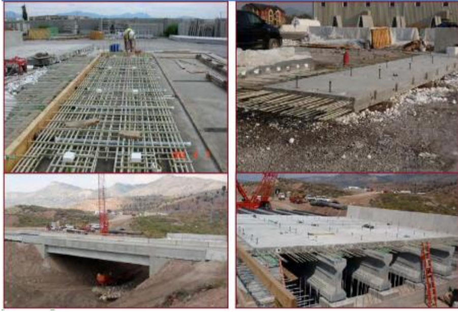
Şekil 3.13. Emma Park Köprüsünde GFRP Kullanımı [1].
