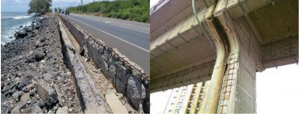
Şekil 3.8. Korozyona uğramış yapı elemanları [1, 23].
