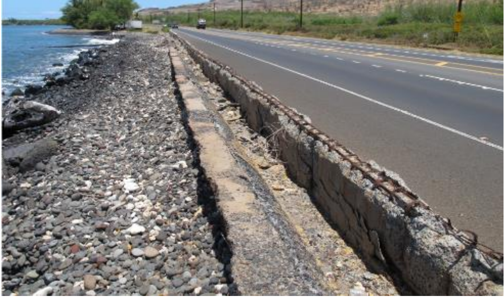
Şekil 3.10. Beton yapı elemanlarında çelik donatı korozyonu [1].
