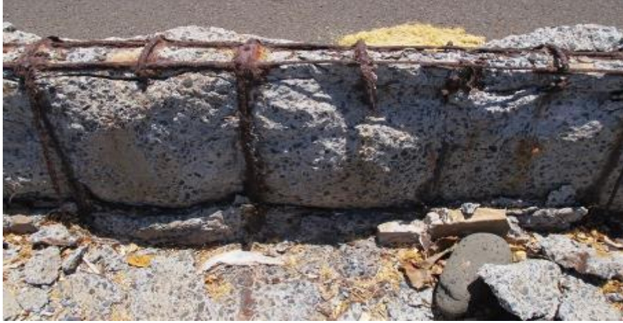
Şekil 1.1. Korozyon sebebiyle özelliğini yitiren bordür [1].
