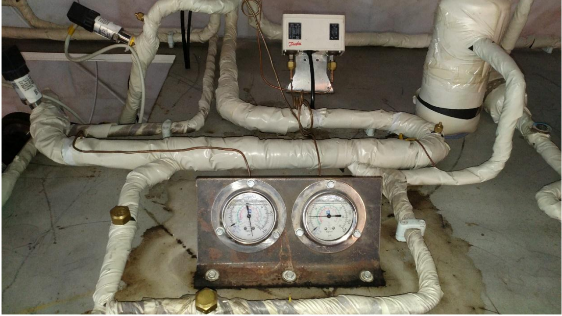
Şekil 4.5. Deneysel iklimlendirme sistemi ısıtma çevrimi ekipmanları
